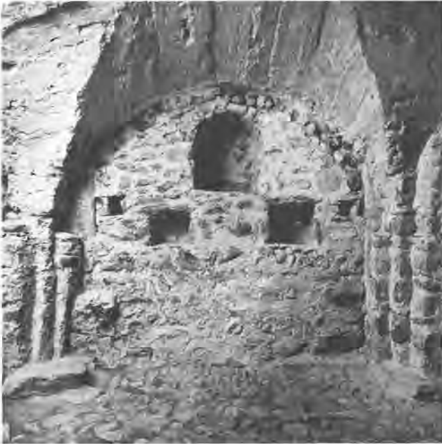
Abb. 24: Unterer Raum (Kapelle?) im westlichen Joch des südlichen Seitenschiffs, Blick gegen Norden
