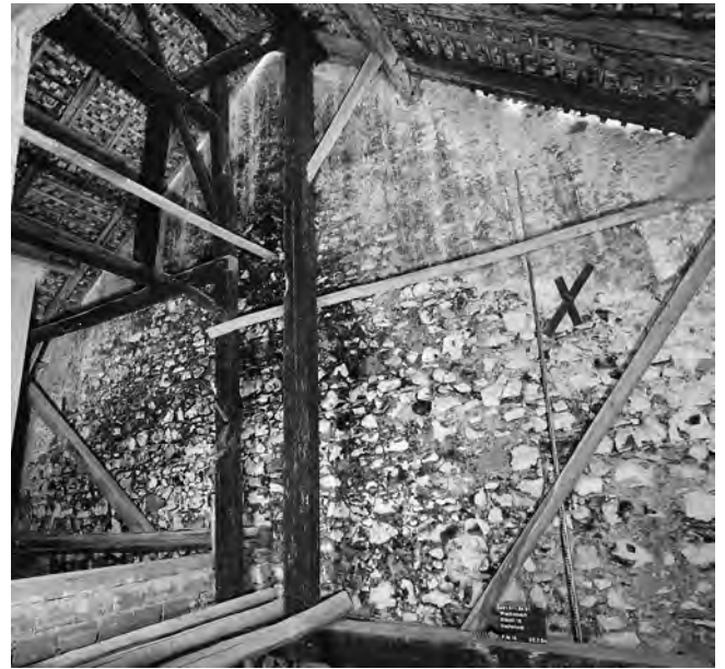
Abb. 60: Städtli 18: Die mittelalterliche Ostmauer (18:97) des ehemaligen Kornhauses ist bis in den Dachstock des Hauses Städtli 18 erhalten. Blick nach Westen.
