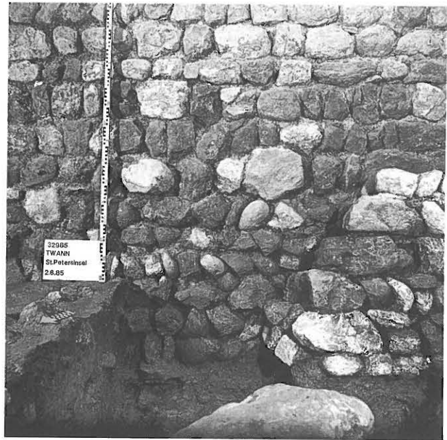
Abb. 121: Nordfundament (147) des südlichen Konventflügels. In der rechten Bildecke die Zungenmauer (89), Bauteil zum Konzept Basilika I. Vgl. Abb. 132.1.
