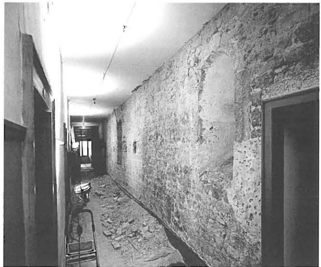
Abb. 220: Übersicht nach Süden der inneren westlichen Obergeschosswand des Ostflügels. Im Vordergrund Fenster (207.8).
