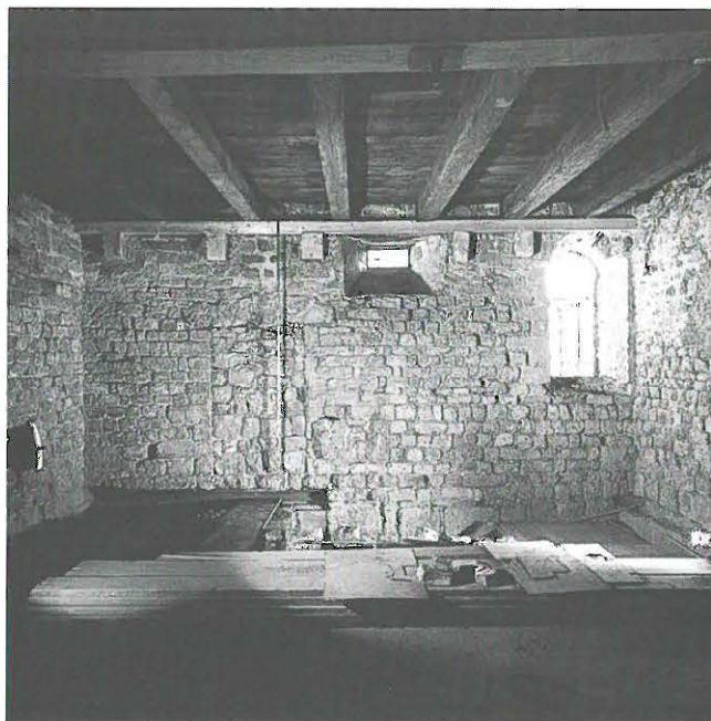
Abb. 195: Kapitelsaal nach Osten nach Wiedarentdeckung und Öffnung des romanischen Fensters rechts. Deutlich sichtbar ist links der Mittelachse das zugemauerte Portal auf den Friedhof der Mönche bzw. in die vermutete Marienkapelle.
