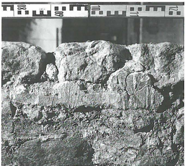
Abb. 84: Putzdetail im Chorinneren. Über dem brandgeschädigten älteren Putz war ein neuer aufgezogen worden, über den dicke Kalksträhnen (Hinweis auf eine Stuckierung?) verflossen sind. Darüber waren Reste von Rotfassung und zuoberst eine alles überziehende Kalkschlämme zu erkennen.
