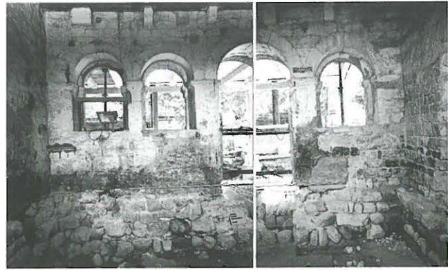
Abb. 193: Kapitelsaal. Westwand auf den mächtigen Fundamenten (91) der westlichen Chorspannmauer von Basilika I.
