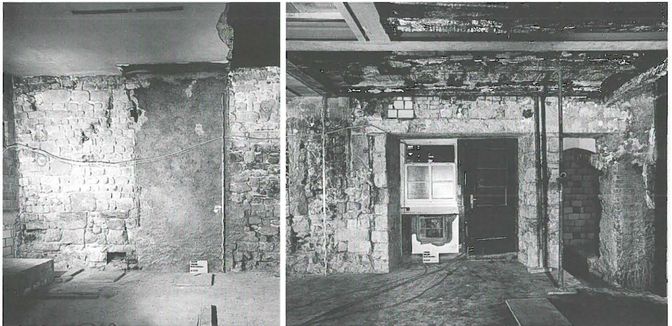
Abb. 227: Innenansicht der stark dezimierten Befunde an der Nordwand (147) im Bereich der Küche (Raum G).
