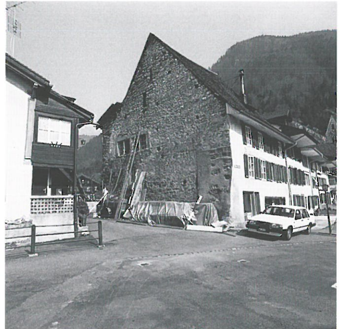
Abb. 10: Unterseen - Obere Gasse 42. Die heutige Liegenschaft von Südosten. Zustand vor der Restaurierung.
