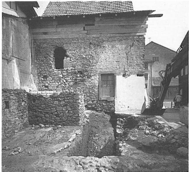
Abb. 20: Unterseen - Obere Gasse 42. Die Westfassade des Hauses von 1517. Im Bereich der ausgebrochenen Flickpartie darf man sich einen rucksackartig vorkragenden Backofen vorstellen.
