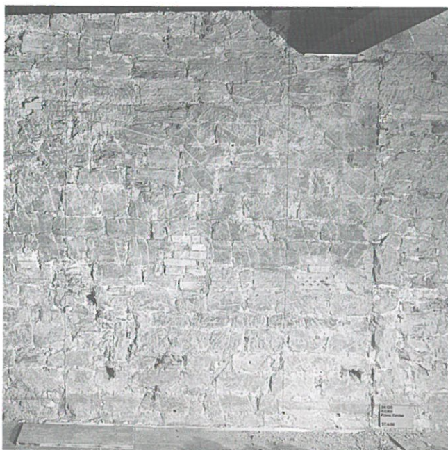
Abb. 47: Fassade Nordannex mit vertikaler Baunaht.
