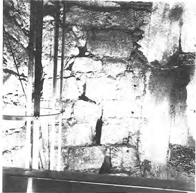
Abb. 4: Befunddetail des grossen Risses.
