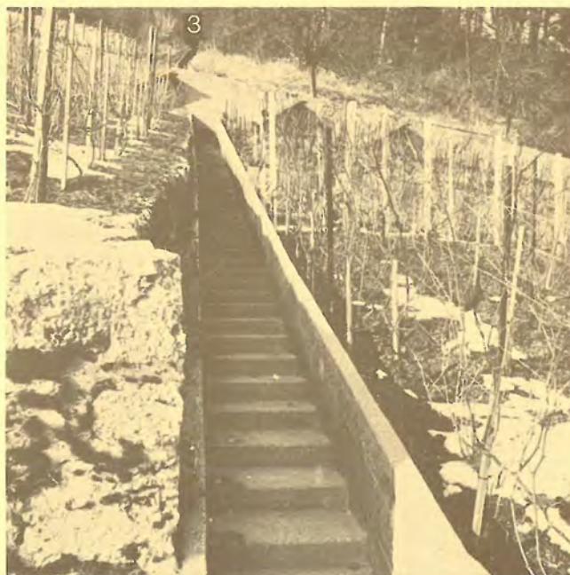
Fig. 23: Douanne. Dépression numéro 3: en haut de l'escalier, servant aussi de canalisation d'eau en cas de pluie, débouche un conduit qui rejoint "l'escalier" de l'autre côté de la route l'emplacement fig. 19).
