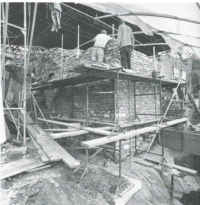
Abb. 115: Studen - Grabefeld / Petinesca 1993–96. Mauersanierungen 1994. Die ursprüngliche Mauerschale der südöstlichen Aussenmauer ist – im Gegensatz zum Kern – nur noch auf wenigen Quadratmetern im Bereich der Südecke erhalten. Die Maurer festigen und ergänzen die Südecke der mächtigen spätrömischen Anlage mit Jurakalksteinen. Blickrichtung Westen.
