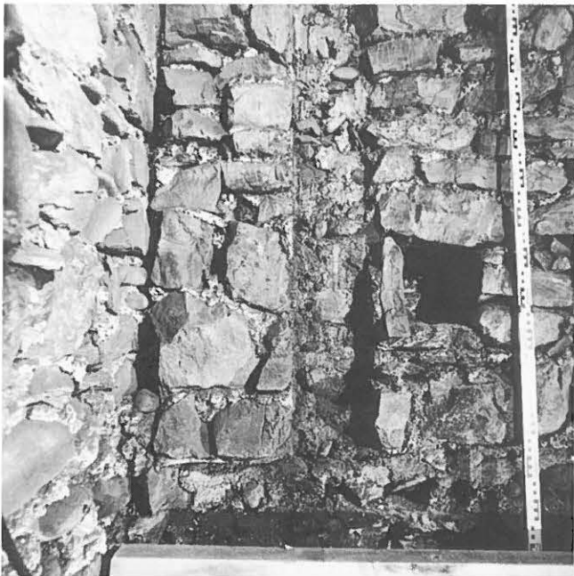
Abb. 425: Thun, Freienhofgasse 20. Westliche Brandmauer. Detail des Anstosses von Mauerwerk (4) an Mauerwerk (2) mit Negativen des älteren Dachstuhls (3).
