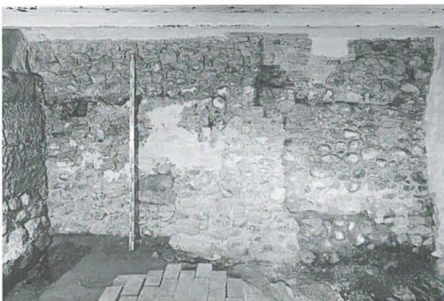
Abb. 317: Laupen, Marktgasse 2. Ansicht an die Stadmauer im Kellerbereich. Deutlich sichtbar ist die horizontale Baunaht für die Unterfangung.
