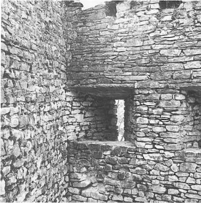
Abb. 474: Wilderswil, Unspunnen. Mauerzustand 1986. Ausbrechende Teile der Schale am Oberen Palas 1986.
