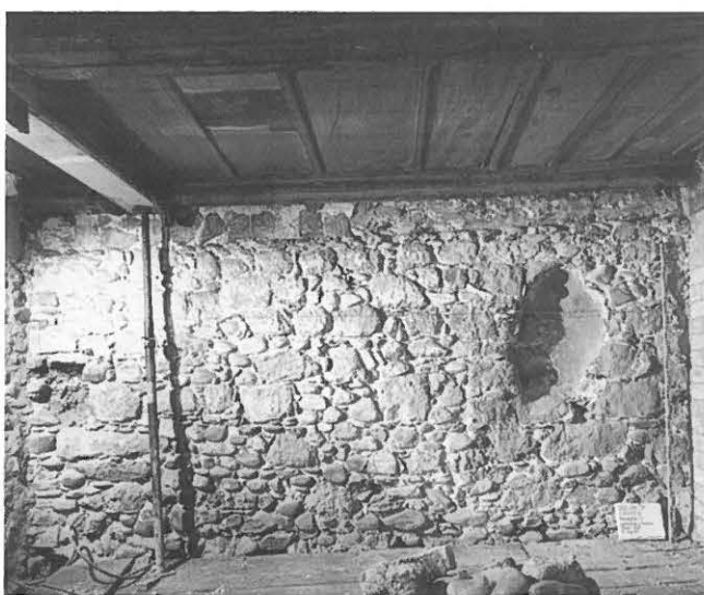
Abb. 311: Laupen, Kreuzplatz 1. Mauerwerk des Kernbaus (Phase I) im Erdgeschoss. Blick nach Nordosten.
