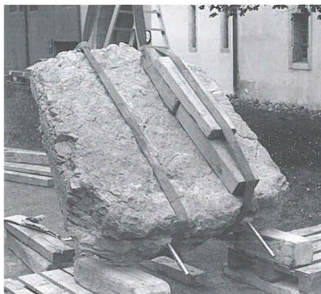
Abb. 20: Laufen - Dolmengrab. Wiederaufstellung 1991. Die mit Chromnickelstahl-Stäben versehene Westplatte wird in die dafür vorgesehenen Bohrlöcher im Magerbeton-Untergrund eingesetzt.
