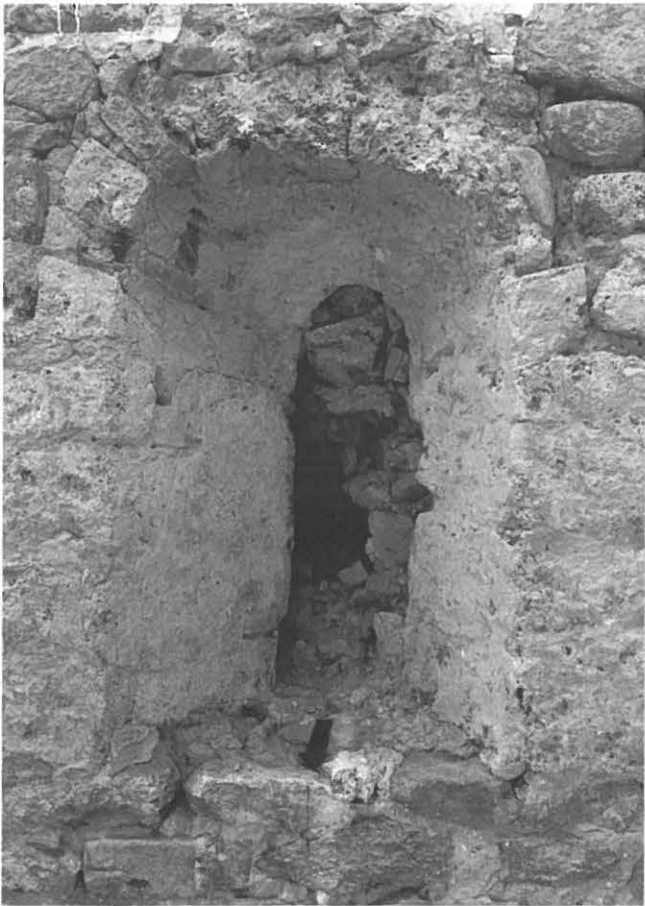
Abb. 6: Das Fenster (105) im Mauerwerk der nach dem Brand wiederhergestellten Anlage IV.
