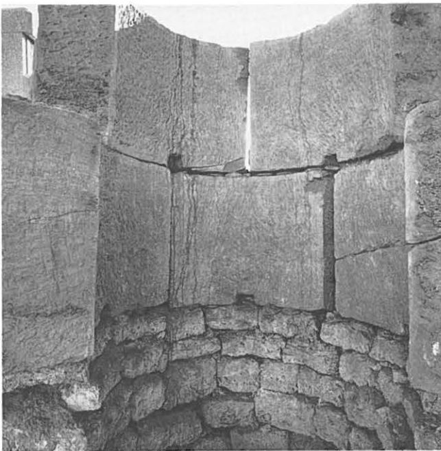
Abb. 107: Bern, Murtenor. Befunddetail des Materialwechsels von Sandsteinquadern zu Tuffmauerwerk.
