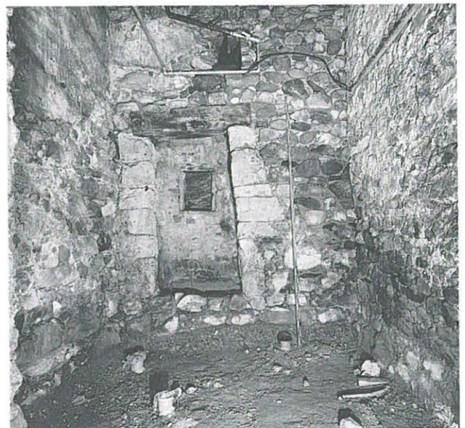
Abb. 243: Thun, Obere Hauptgasse 58. Gassenwärts zugemauertes Kellerportal mit Eichensturz im Mauerverband des Kernbaus (1230–35).
