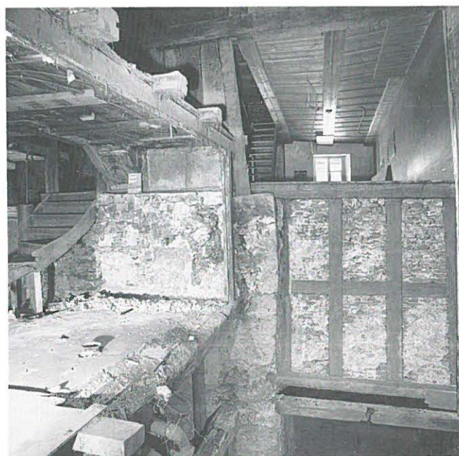
Abb. 281: Wiedlisbach, Städtli 13. Ansicht im 1. Obergeschoss des Innern nach Süden. In der Bildmitte die Nordwestecke des turmartigen Kernbaus.
