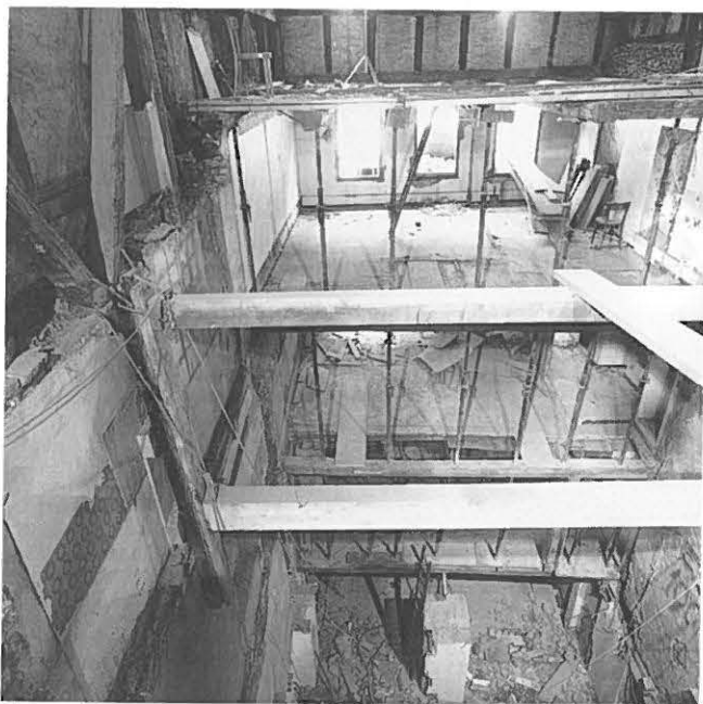
Abb. 239: Thun, Obere Hauptgasse 29. Blick in die ausgekernte Liegenschaft gegen die Hauptgasse, wo Schubladen ähnlich die barocken Täferstuben erhalten blieben.
