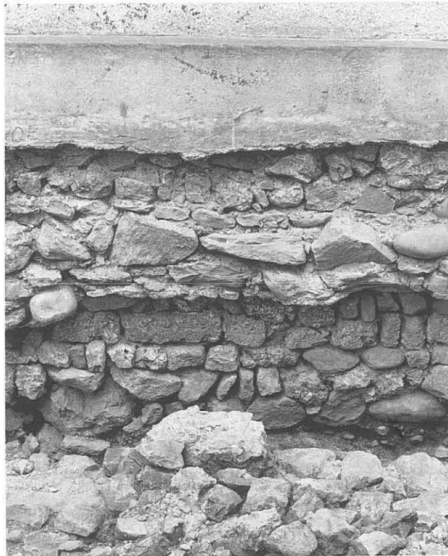
Abb. 5: Südmauer des Schiffes. Das älteste mittelalterliche Fundament (6); darüber das Fundament (7) der romanischen Kirche.
