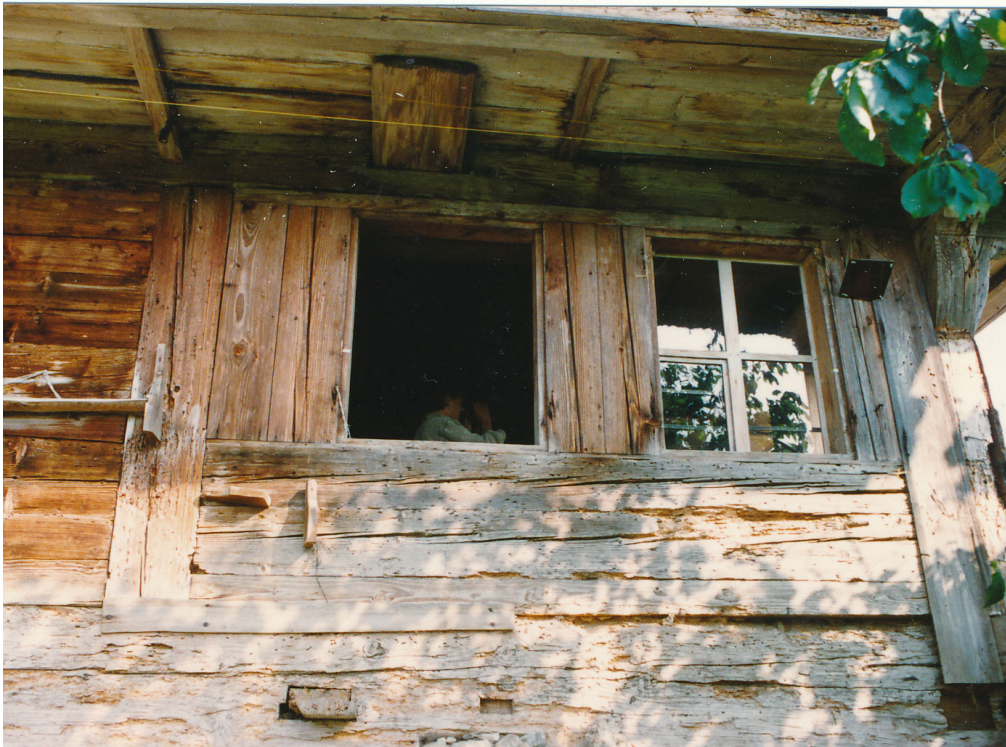
23 Trotz teilweise schadhafter Holzbalken war die Baukonstruktion gut erhalten und ablesbar (Denkmalpflege des Kantons Bern, Archiv, Fotograf Ernst E. Anderegg, Meiringen, 1988-92).
