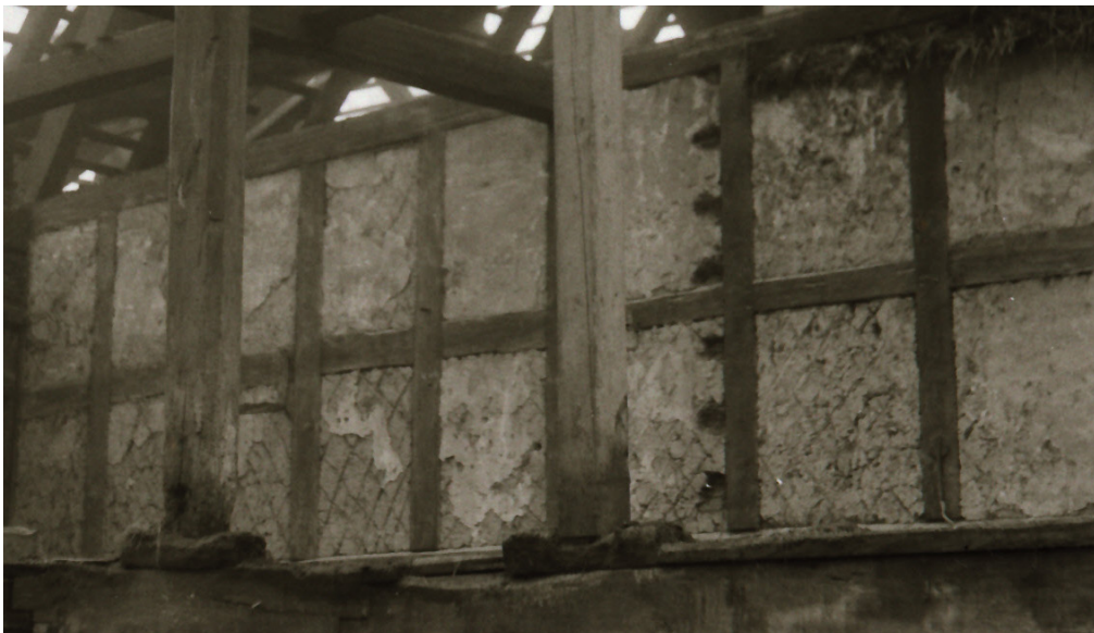
23 Balkenlöcher in den Gefachen im Obergeschoss des Tenns zeugen von einem ehemaligen Einbau. Foto, 1974 (FLM, BalFot 19670).
