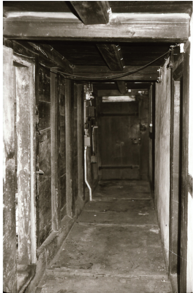
12 Die Erschliessung der Wohnräume über einen Quergang wurde erst um 1834 hinzugefügt. Blick nach Osten zum Haupteingang, Foto, 1974 (FLM, BalFot 19661).
