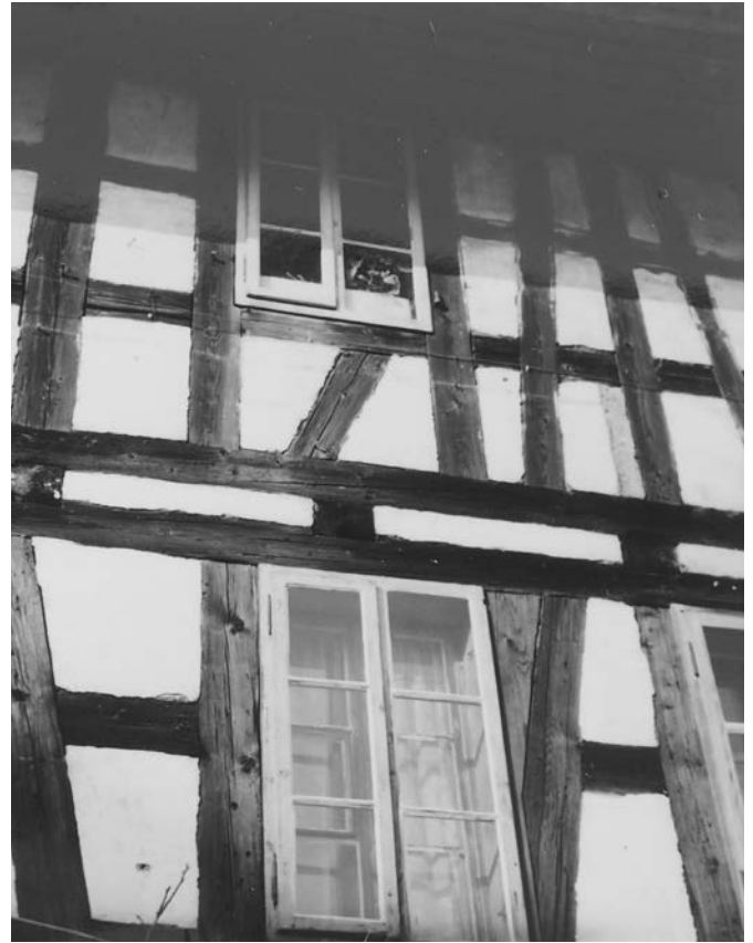
19 Das nachträglich in die Südfassade eingebrachte mittige Fenster im Hauptgeschoss beschnitt eine Diagonalstrebe. Foto, vor 1969 (FLM AltA 514).
