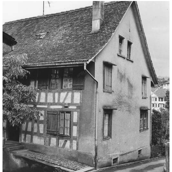
11 Ansicht von Nordwesten auf die massiv gemauerte Wetterseite und die anschliessende, erneuerte Fachwerkwand, Foto, vor 1969 (FLM AltArch 514).
