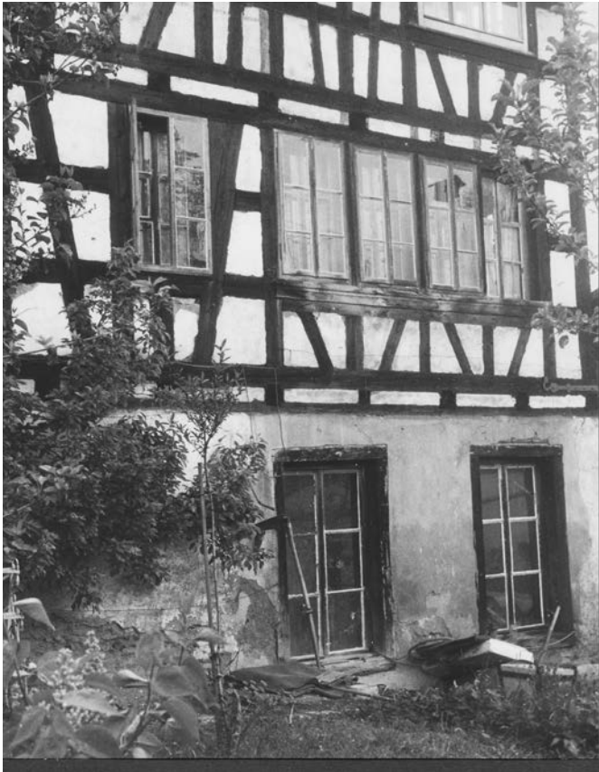
18 Auf der rechten Seite der Südfassade waren am ehemaligen Standort in den Sockel zwei grosse Fensteröffnungen eingebrochen. Foto, vor 1969 (FLM AltA 114).
