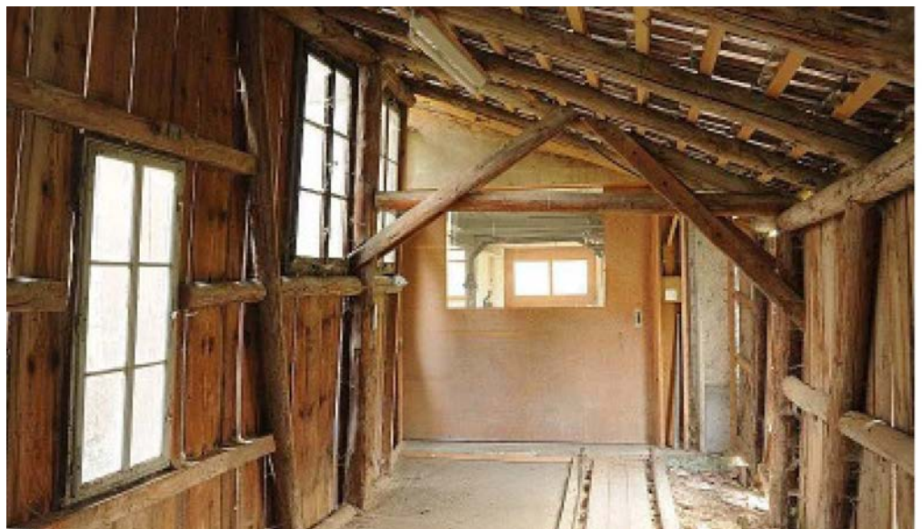
13 Im Westen war das Gebäude durch den Bau einer Schreinerei gekürzt worden. Zwischen der Schreinerei und der ehemaligen Seilerei wurde eine Schiebetüre eingebracht. Foto, 2010 (FLM, 1061-Unterägeri. Fotos alter Standort, Lidostrasse 21, 058_VS).
