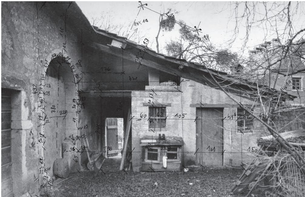
12 Die Hofansicht dokumentiert die Nutzung des hofseitigen Anbaus als Hühnerstall. Fotogrammetrische Bauaufnahme, 1984 (FLM Alta 111).
