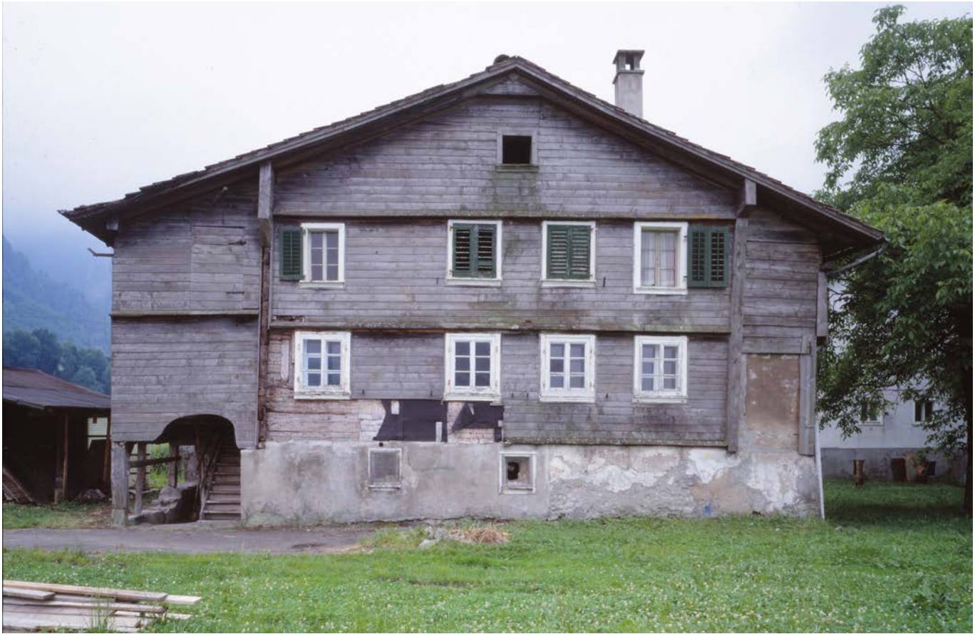
11 In die Nordfassade des Wohnhauses aus Schwyz SZ waren nachträglich Fensteröffnungen eingebracht worden. Dia: Georg Sidler, vor 1997 (FLM BalFot 54703)
