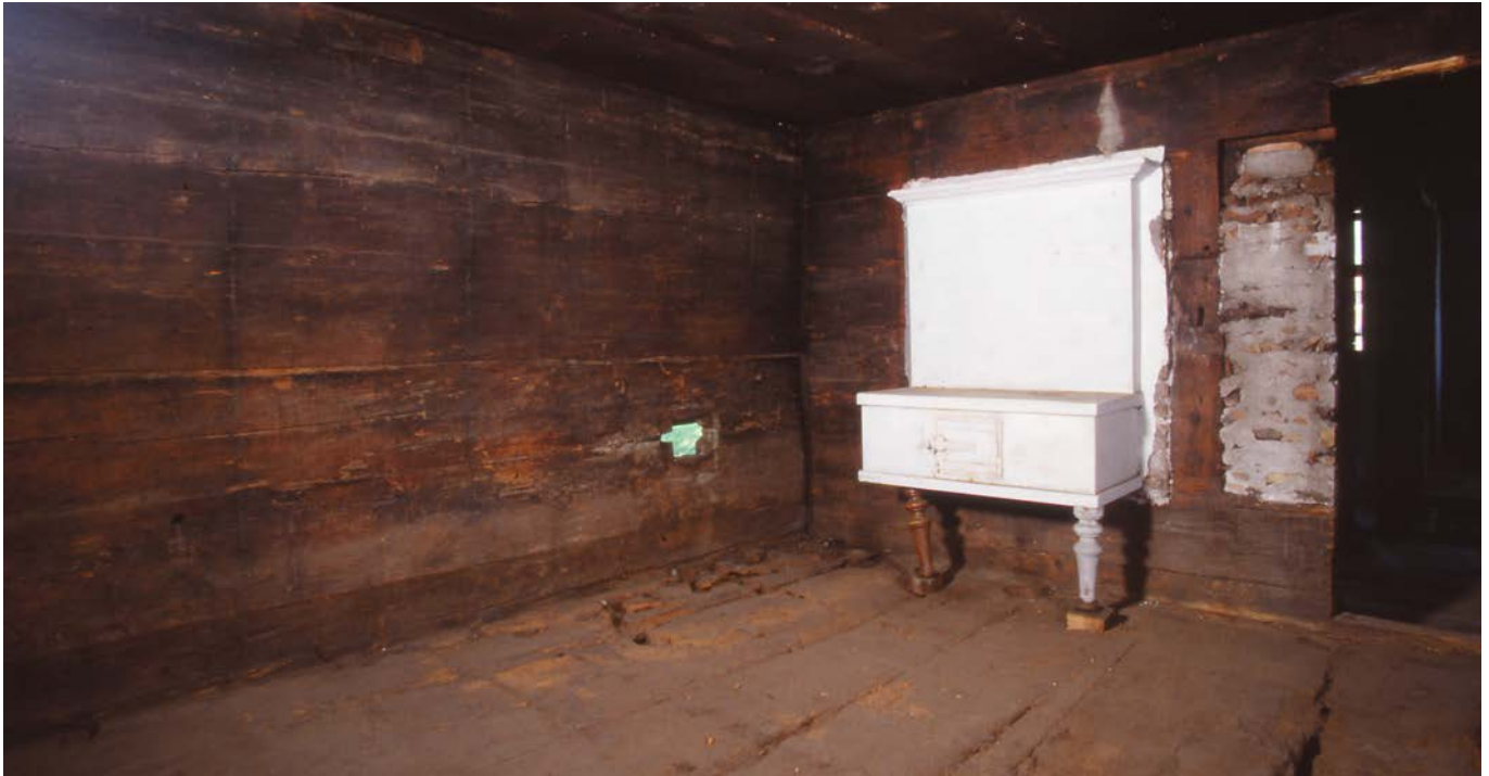
27 Neben dem Zugang zur Nebenstube befand sich ein zugesetzter, älterer Eingang. In der Westwand, neben der Ofenbank befand sich ein Loch, an dem Harnstoffe festgestellt wurden. Vermutlich lag in dem Raum zeitweise eine pflegebedürftige Person. Dia: Georg Sidler, Juli 1995 (FLM BalFot 54240).
