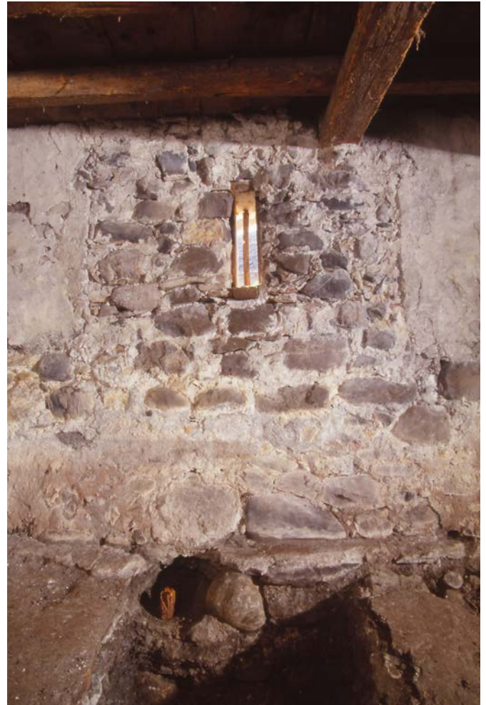
9 In der Südwand im Sockelgeschoss befand sich eine zugesetzte große Fensteröffnung. Dia: Georg Sidler, Juli 1995 (FLM BalFot 54227)
