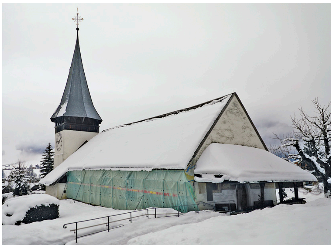
Abb. 1: Zweisimmen, Kirche. Unter dem Wetzschutz konnte die Nordfassade des Langhauses untersucht werden. Blick nach Südosten.
