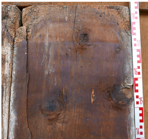
Fig. 8: La Neuveville, rue du Collège 5. Madrier découvert en remploi dans le sol de la cuisine du 1 er étage. Daté de 1507 par la dendrochronologie, il appartenait au plafond-plancher du 2 e étage.
