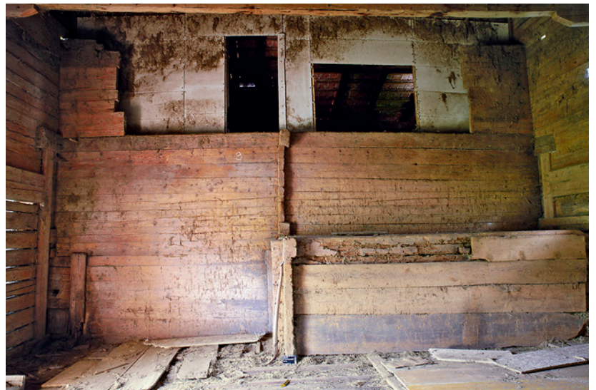
Abb. 7: Aeschi b. Spiez, Suldhaltenstrasse 31. Nordfassade des Wohnteils vom Heuboden aus gesehen. Die Blockkonstruktion der Nebenstube von 1779 springt in die Ökonomie vor. Darüber liegt die durchlaufende Blockwand zum Gaden des Ursprungsbaus von 1559. Hierauf ruhen wiederum die Enden der Blockvorstösse der 1849 neu angefügten grösseren Ökonomie.
