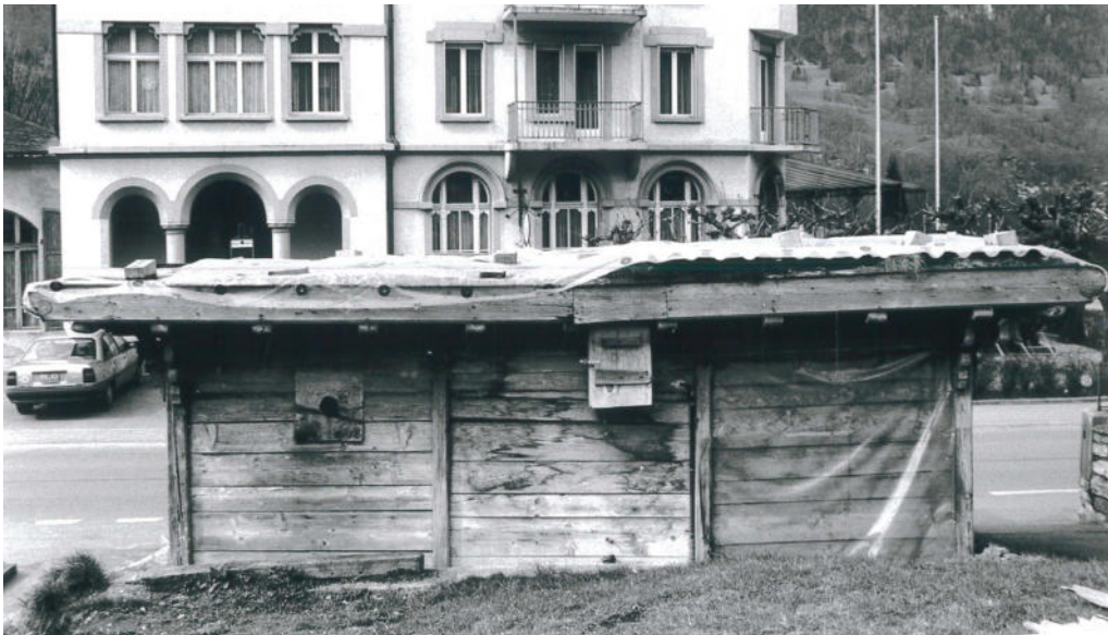
7 Die rückwärtige, geschlossene Südostseite des Kiosks war in den Hang eingetieft. Foto, 1993 (FLM digKat).
