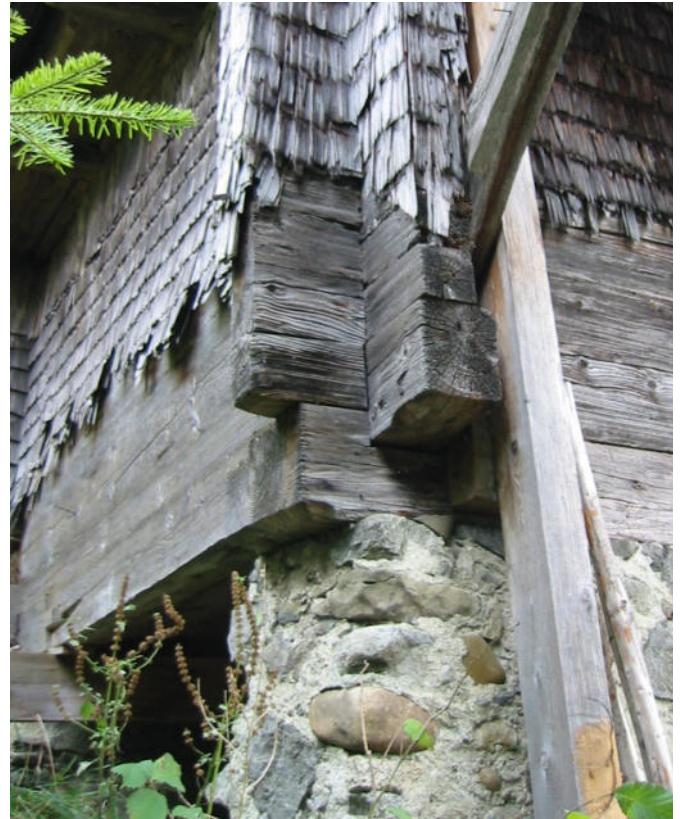
8 Der ältere Teil der Speichers wurde als Blockbau mit Eckgewält konstruiert. Ansicht Westecke unten. Foto, 2002 (FLM digKat).
