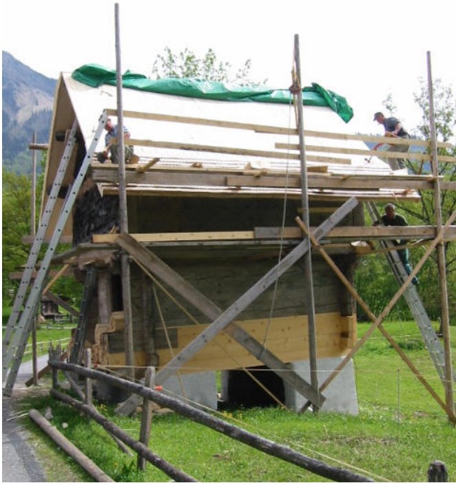
22 Das Dach des Speichers wurde mit Holzschindeln gedeckt. Die unteren Balken der ehemaligen Hangseite wurden erneuert und ergänzt. Foto, 2003 (FLM, digKat).
