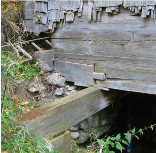
11 Durch die Feuchtigkeit an der Hangseite waren Ausbesserungen und Stützkonstruktionen notwendig geworden. Ansicht Nord Foto, 2002 (FLM digKat).
