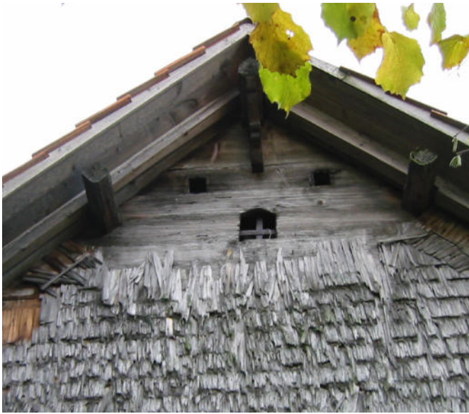
14 Das Giebfeld auf der Nordwestseite. Die mittige Fensteröffnung war mit einem Eisengitter versehen. Foto, 2002 (FLM digKat).
