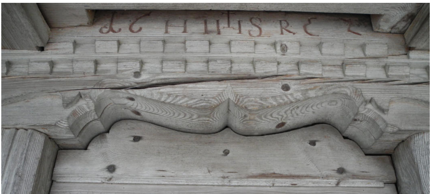
24 Die Bauinschrift «16 H IHS R 52» wurde im Freilichtmuseum freigelegt und lesbar gemacht. Foto, 2003 (FLM, digKat).
