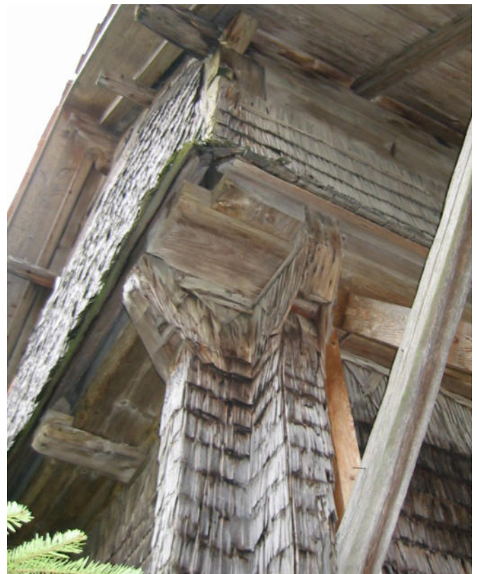
9 Auf den 1652 errichteten Speicherbau wurde hundert Jahre nach Erbauung ein zweites Geschoss aufgesetzt. Ansicht Westecke oben. Foto, 2002 (FLM digKat).
