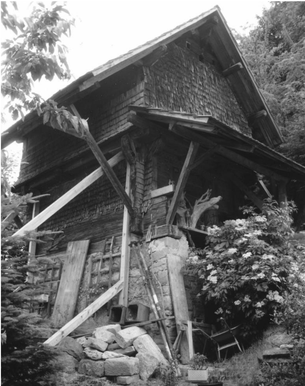
10 Im 20. Jahrhundert war der Sockelbau teilweise eingestürzt, vor dem Zugang wuchs ein großer Holunderbusch. Provisorische Stützkonstruktionen waren zur Stabilisierung des Gebäudes notwendig. Ansicht Süd. Foto, September 1943 (FLM BildA 38141).
