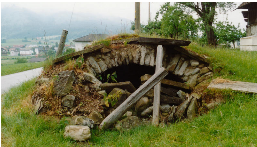
7 Die Eingangsfassade und der nördliche Teil des Kellers waren eingestürzt. Foto, 2007 (FLM, digKat).
