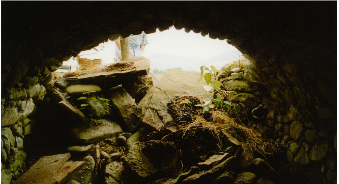
12 Der Eingangsbereich des Kellers war mit dem eingestürzten Baumaterial verfüllt. Foto, 2007 (FLM, digKat).
