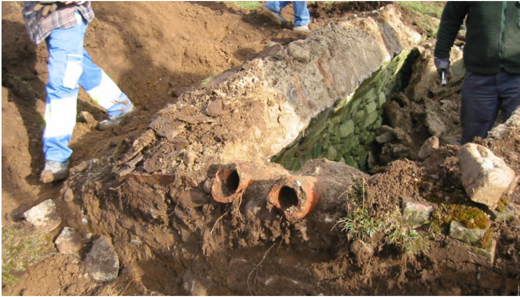
13 Die zur Lüftung schräg in die Rückwand eingemauerten Tonröhren sind auf dem Abbruchfoto besonders gut zu sehen. Foto, 2007 (FLM, digKat).
