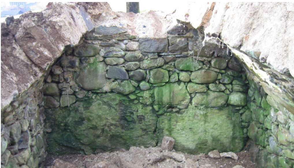
14 Zwei vertikal verlaufende Abdrücke auf der Rückwand zeigen auf dem Abbruchfoto die Lage der ehemaligen Einbauten. Foto, 2007 (FLM, digKat).
