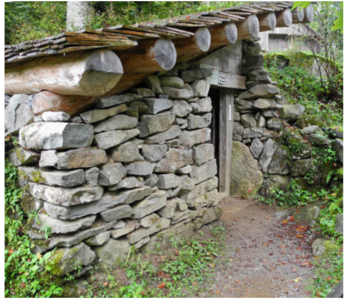
10 Auch das dritte Dach war wenig authentisch. Ansicht Nord, Foto 2013 (FLM BildA).
