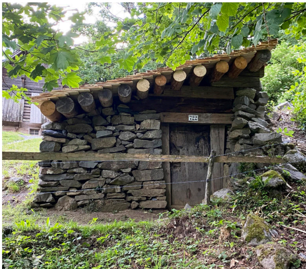
13 Das aktuelle Dach wurde vom Urner Holzbildhauer Toni Walker mit Schindeln aus Unterschächen gedeckt. Ansicht Nordwest, Foto 2021 (FLM BildA).
