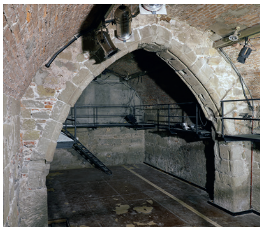
1 Bern, Kramgasse 4. Der Gurtbogen von Süden. Die ungleichmässig breiten Fugen geben bereits einen Hinweis darauf, dass der Bogen nicht original an dieser Stelle sitzt, sondern wiederverwendet und ohne grosse Sorgfalt aufgemauert wurde.
