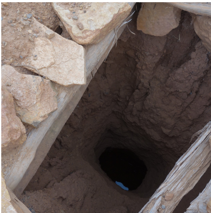
Une cheminée d'aération, avec l'eau visible au fond. A noter que comme le bord n'est pas suffisamment surélevé, de l'eau s'infiltre et érode les bordures du puit, ce qui conduit à leurs effondrements. (Stefan Graf)
