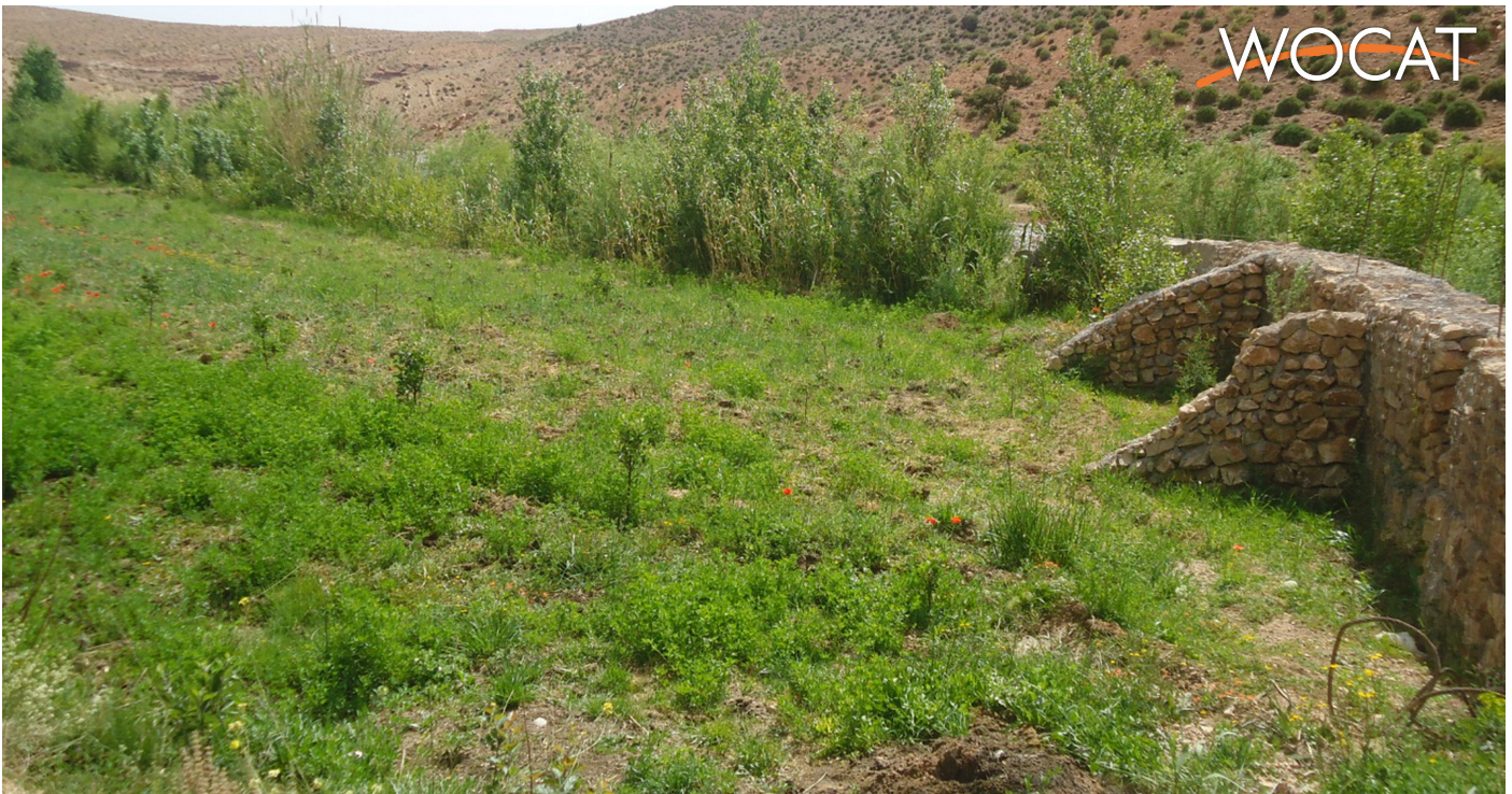
Mur de soutènement en gabion avec contreforts pour protéger les terres cultivées situé sur les berges d'Oued Outat. (Said Aouddou)
