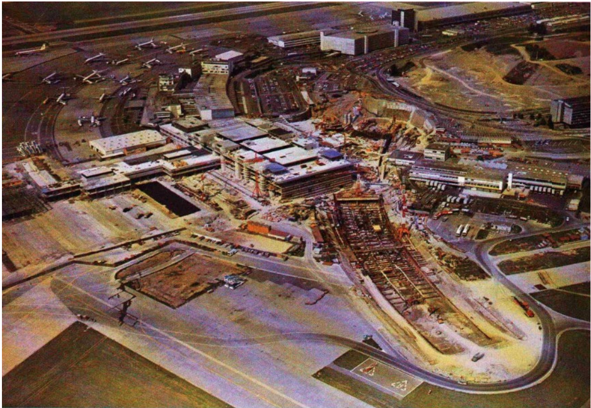
Abb. 8: Blick von Südwesten auf die Baustelle des Flughafenbahnhofs Zürich. Aufnahme vom Mai 1974. Anonyme Fotografie. Quelle: Flughafenlinie Zürich Eröffnung 1. Juni 1980: 12; SBB Historic FRE_WELTI_2005/003_010.
