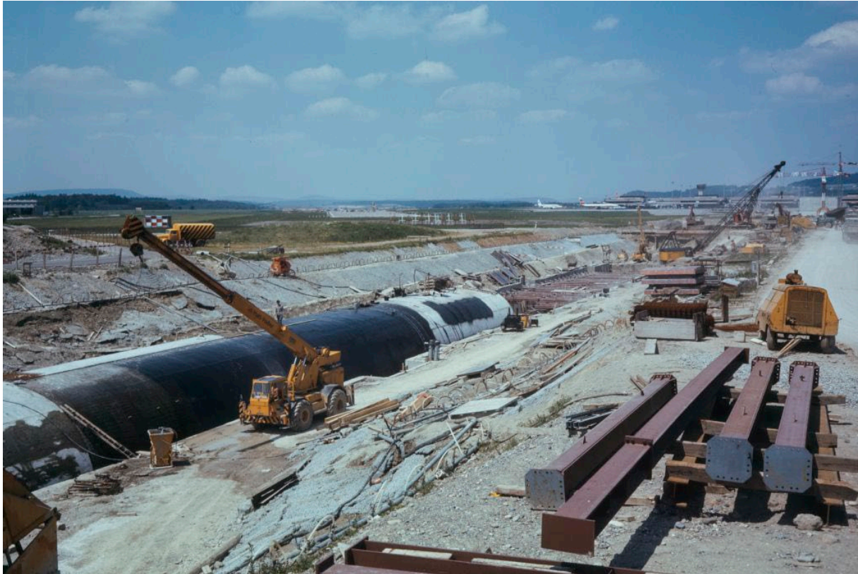
Abb. 9: Tunnelbau SBB, Flughafenlinie. Aufnahme vom 22.06.1976. Fotografie von Hans Krebs. Quelle: COM C25-039-003.
