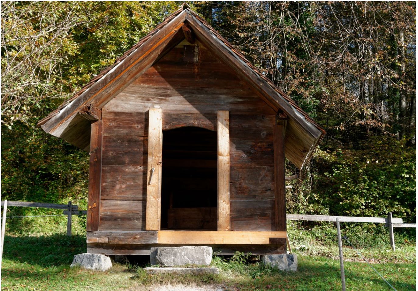
15 Freilichtmuseum der Schweiz, Kornspeicher aus Montsevelier: Im Jahr 2011 wurden die Türpfosten sowie Teile des Schwellenkranzes ersetzt. Diese Massnahmen sind auf dieser Aufnahme noch gut zu erkennen, das Holz ist seitdem nachgedunkelt. Blick nach Nordosten. Aufnahme 2014.
