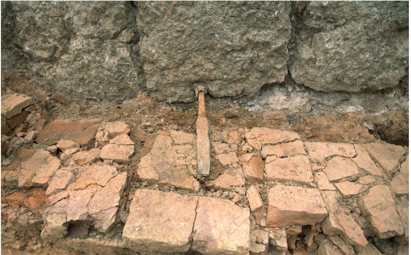
12 Péry, Planche Nanry: Bei der Freilegung des Ziegelofens wurden in der aus Grünlingen gemauerten Isolierschicht kurze Eisenstäbe entdeckt. Sie sorgten für eine Stabilisierung der inneren Isolierung und eine sichere Verbindung mit dem Kalksteinmantel. Aufnahme 2016.
