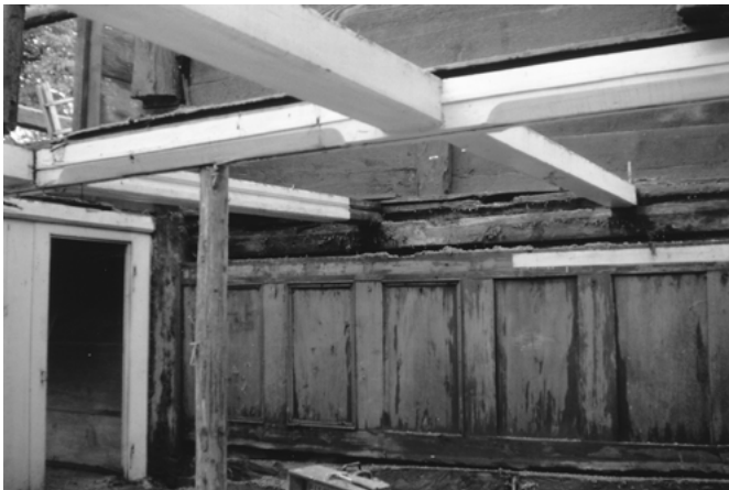
29 Oberentfelden, Schustergässli 1/3: Blick in das Zimmer der Nordostecke des Wohnteils während des Abbaus. Der Raum ist mit einem wandhohen Feldertäfer ausgestattet. Die Balkenkonstruktion der Bohlendecke, die dort seitlich in die Nuten eingelassen war, zeigt charakteristische breite Fasungen des 17. Jahrhunderts. Die Trennwand zur südlichen angrenzenden Stube des östlichen Hausteils ist bereits entfernt, nur noch ein Ständer ist davon zu sehen. Die Tür im Hintergrund führt in die Stube des westlichen Wohnteils. Blick nach Nordwesten. Aufnahme 1983.
