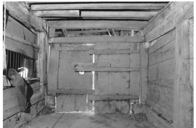
30 Oberentfelden, Schustergässli 1/3: Blick auf das östliche Tenntor, das sich zur Gartenseite öffnet. Linker Hand liegt der Stallteil, rechter Hand ist die Ständer-Bohlenwand des Wohnteils zu sehen. Blick nach Osten. Aufnahme 1983.
