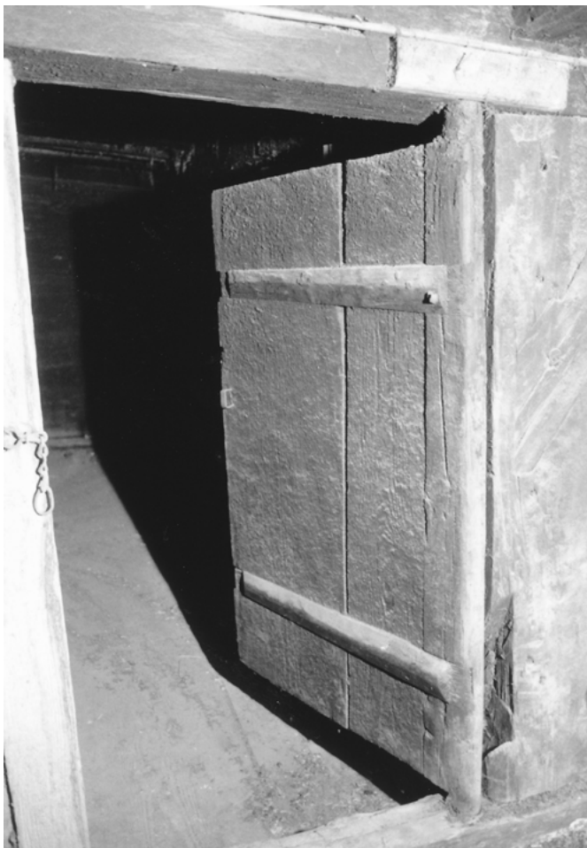
32 Oberentfelden, Schustergässli 1/3: Blick in eine der Gadenkammern, die noch mit der vermutlich originalen Bretttertür ausgestattet ist. Sie wird von zwei eingeschobenen Gratleisten zusammengehalten. Blick vermutlich nach Osten. Aufnahme 1983.
