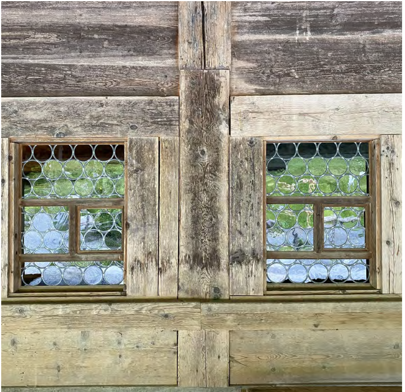
44 Freilichtmuseum der Schweiz, Bauernhaus aus Oberentfelden: Wiederhergestellte Fassade des Wohnteils mit zwei der rekonstruierten Stubenfenster mit butzenförmiger Bleiverglasung. Im Museum ist die Fassade jetzt nach Norden zum Weg gerichtet. Aufnahme 2020.
