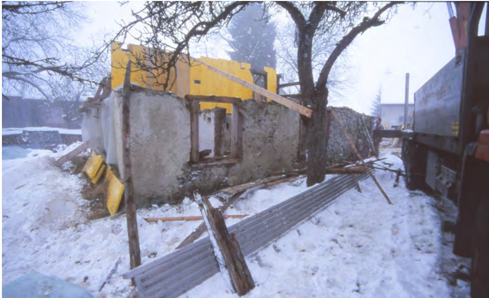
28 Leutwil, Zopfhusi: Die Südostecke während der Translozierung. Das Hochständergerüst im Gebäudeinneren ist mit Schaltafeln geschützt. Blick nach Nordwesten. Aufnahme Januar 1999.
