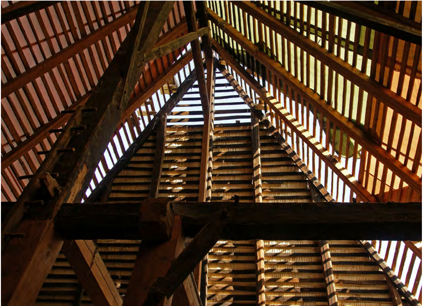
19 Freilichtmuseum der Schweiz, Bauernhaus aus Madiswil BE. Die teilweise alte und stellenweise erneuerte Dachkonstruktion über dem Stall. Aufnahme 2009.
