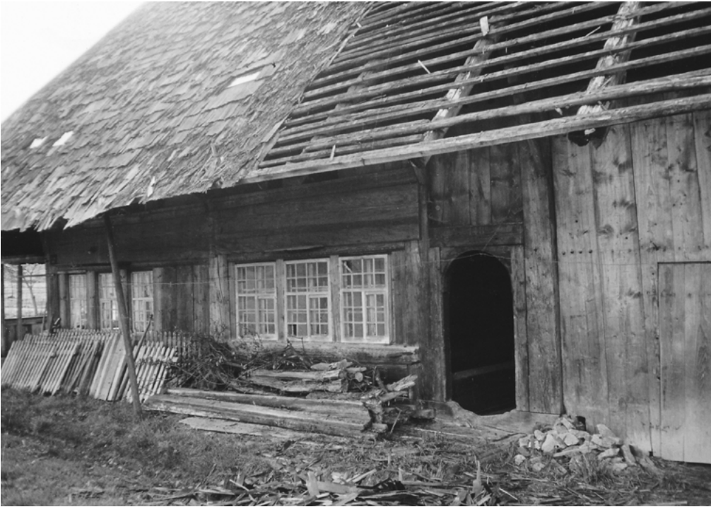
9 Madiswil, Bennacker: Östliche Längsseite des Hauses. Gut zu erkennen sind die südliche Hauptstube links mit einem verschlossenen Fenster und die Nebestube ebenfalls mit drei Fenstern inklusive Vorfens-tern. Der östliche Hauszugang und das Tenntor mit Mannstori. Aufnahme vor 1975.
