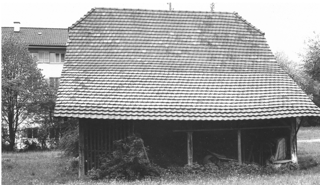
16 Ostermündigen, Mitteldorfstrasse 20: Nördliche Trauffassade mit dem später abgeschleppten, weit heruntergezogenen Dach mit Falzziegeldeckung. Darunter verbirgt sich die jüngere Remise. Blick nach Süden. Aufnahme 1977.
