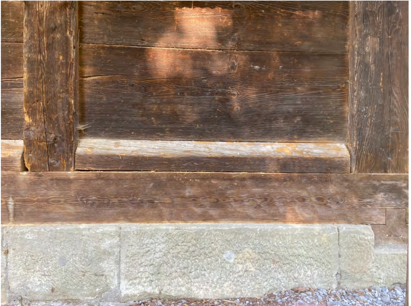
25 Freilichtmuseum der Schweiz, Speicher aus Ostermundigen: Wiederaufgebauter Schwellenbereich des Kornspeichers. Die erneuerte Schwelle liegt nicht mehr wie ursprünglich auf den Kellermauern, sondern stattdessen auf einem neu gebauten Sockel aus Ostermundiger Sandstein. Die wieder eingebaute, historische Bohlenwand wird am unteren Ende durch eine schräge Blockbohle als Wassernase abgeschlossen. Aufnahme 2022.
