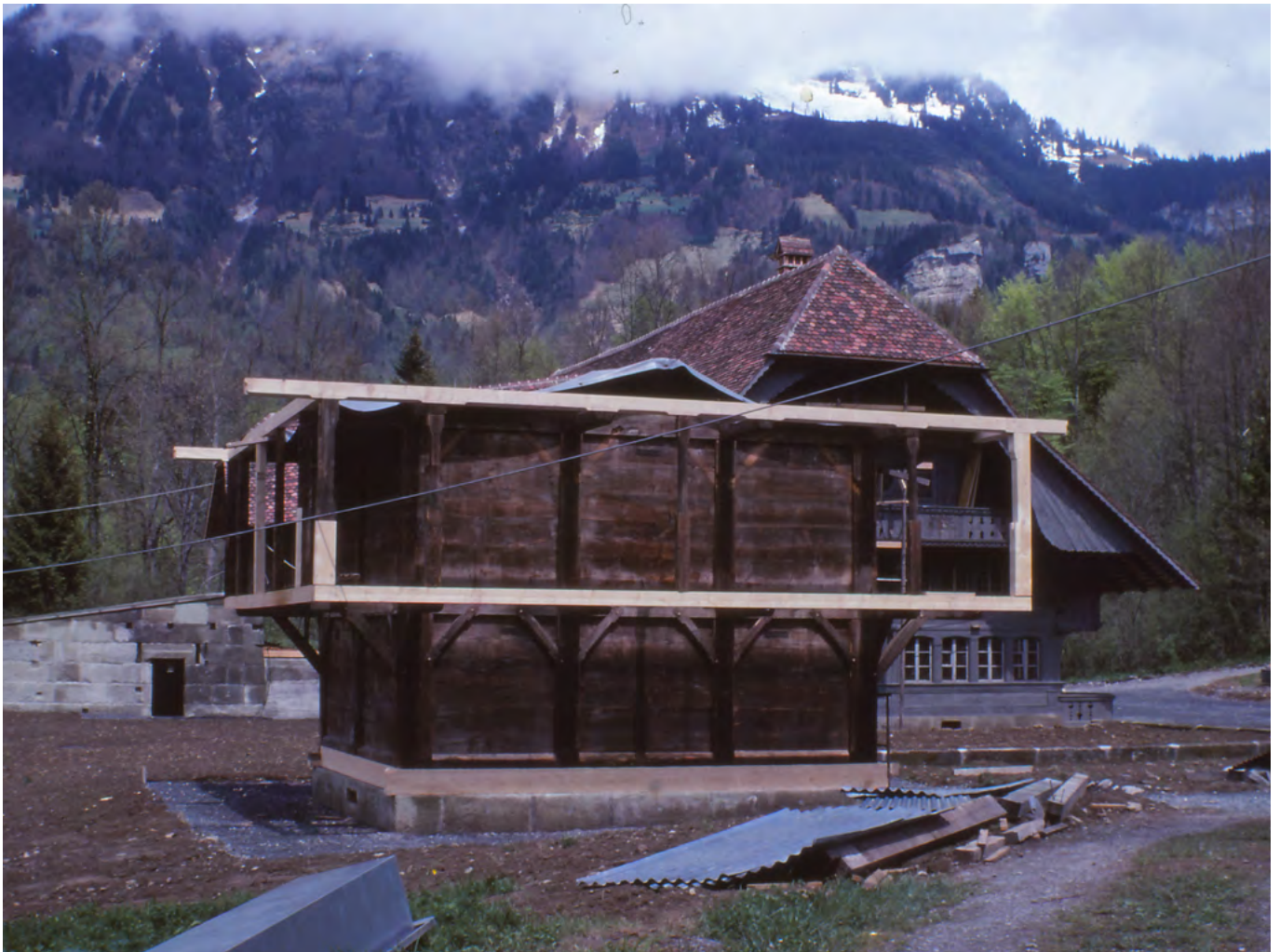
24 Freilichtmuseum der Schweiz, Speicher aus Ostermundigen: Wiederaufbau des Kornspeichers. Die erneuerten Bauteile heben sich wie die Schwellen und die Laubenkonstruktionen deutlich durch das hellere Holz vom historischen Bestand ab. Blick nach Norden. Aufnahme 1978.
