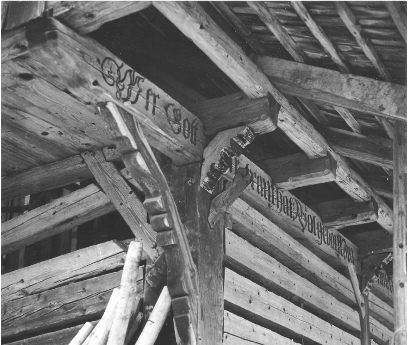
7 Faulensee, Schüpfgut, Pferde- und Ausfütterungsstall: Blick unter die südöstliche Dachtraufe der Stallscheune, die laut Inschrift 1702 von Abraham von Graffenried gebaut worden ist. Neben der mit schwarzer Farbe aufgemalten Inschrift «Wer Gott vertraut hat Wol gebaut ...» zeigt das herrschaftliche Stallgebäude reich profilierte Büge, mit denen die vorkragenden dachtragenden Anker- und Stichbalken mit Flugpfetten abgestützt sind. Aufnahme 1969/70.
