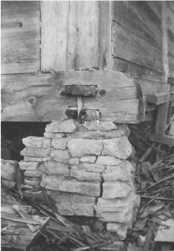
10 Wasen im Emmental, Obere Schützenalp: Um den Käsespeicher vom Erdboden abzuheben, wurde der hölzerne Baukörper auf Stützen aus geschichteten Steinen gestellt. Der darüberliegende Schwellenkranz war mit einem doppelt gezapften Schwellenschloss und Holznagel gesichert. Beide waren jedoch zum Zeitpunkt des Abbaus bereits stark beschädigt. Aufnahme etwa 1978.
