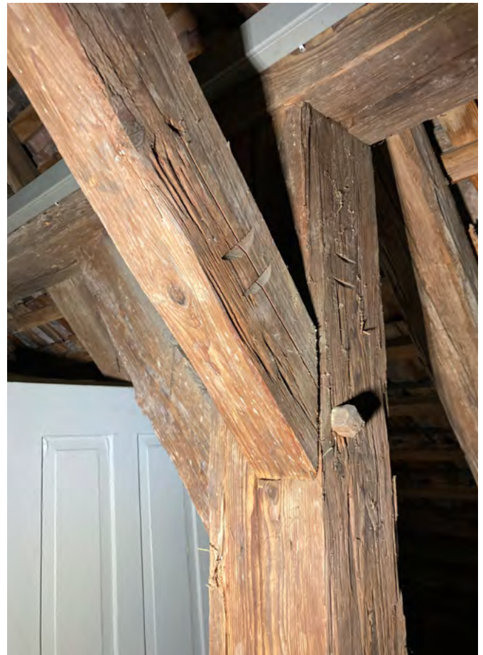
9 Freilichtmuseum der Schweiz, Handwerkerhaus aus Herzogenbuchsee: Das Handwerkerhaus wurde von versierten Handwerkerkern errichtet. Für die Holzkonstruktion waren Zimmermänner verantwortlich, die das Holzgerüst auf dem Werkplatz vorfertigten und am Bestimmungsort aufbauten. Um die Hölzer in der richtigen Reihenfolge aufzurichten, wurden diese auf dem Werkplatz mit Abbundzeichen markiert. Blick nach Norden. Aufnahme 2023.
