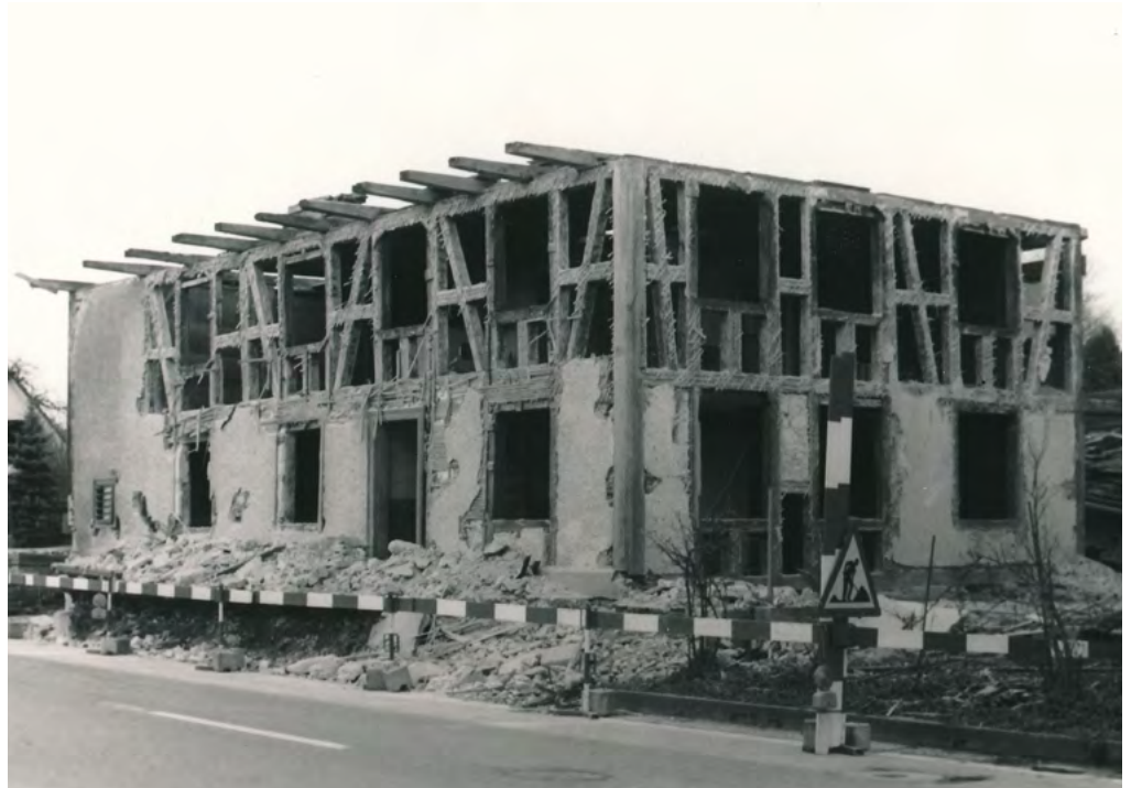
13 Herzogenbuchsee, ehemalige Zürichstrasse 36: Die symmetrisch angelegte Fachwerkkonstruktion kam erst beim Abbau des Gebäudes zum Vorschein. Blick nach Nordosten. Aufnahme 1983.
