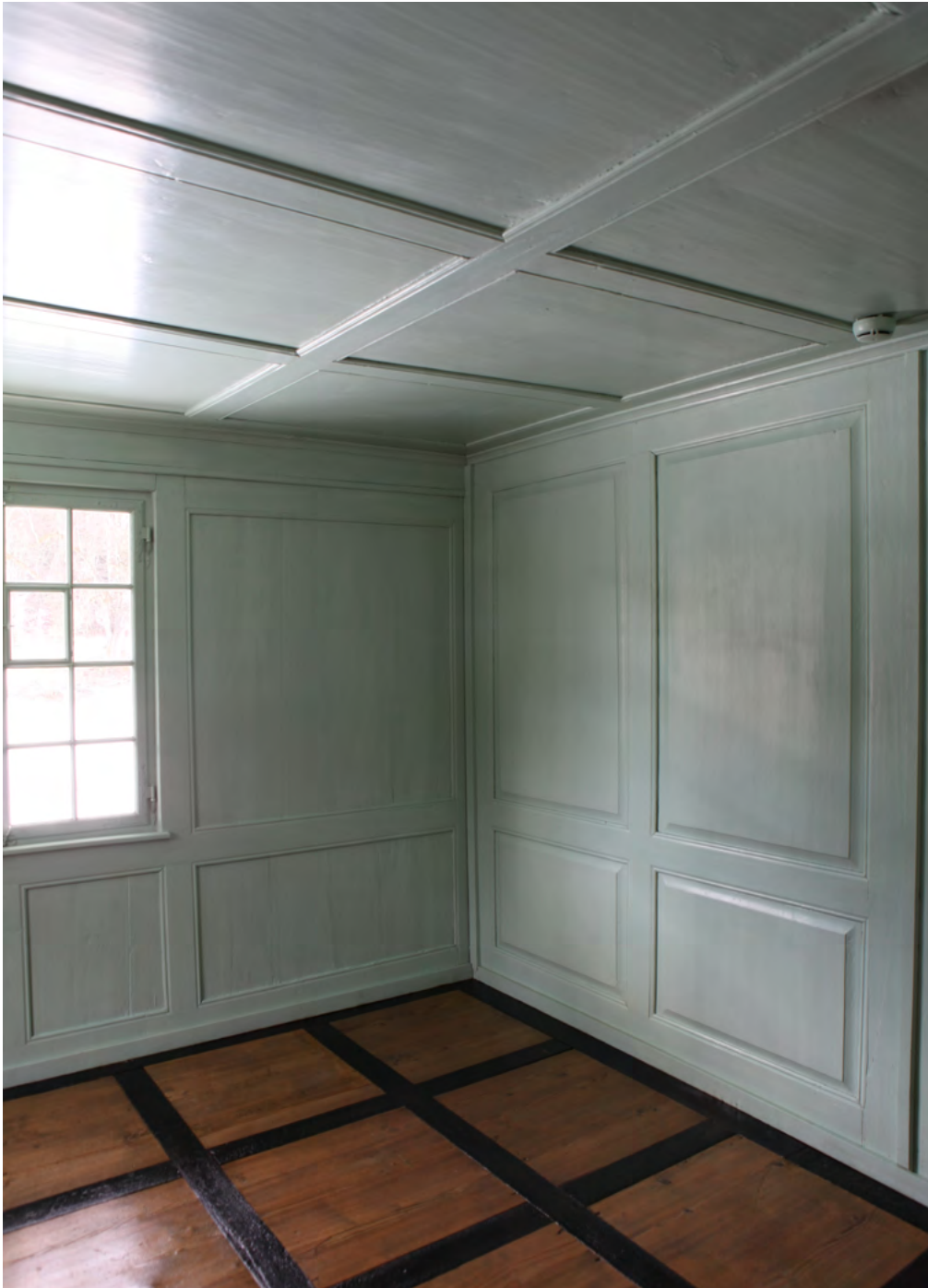
33 Freilichtmuseum der Schweiz, Handwerkerhaus aus Herzogenbuchsee: Das nun südöstlich gelegene frühere Arbeitszimmer im Obergeschoss, kurz nach einer Instandsetzungsmaßnahme der Böden und des Täfers. Aufnahme 2013.
