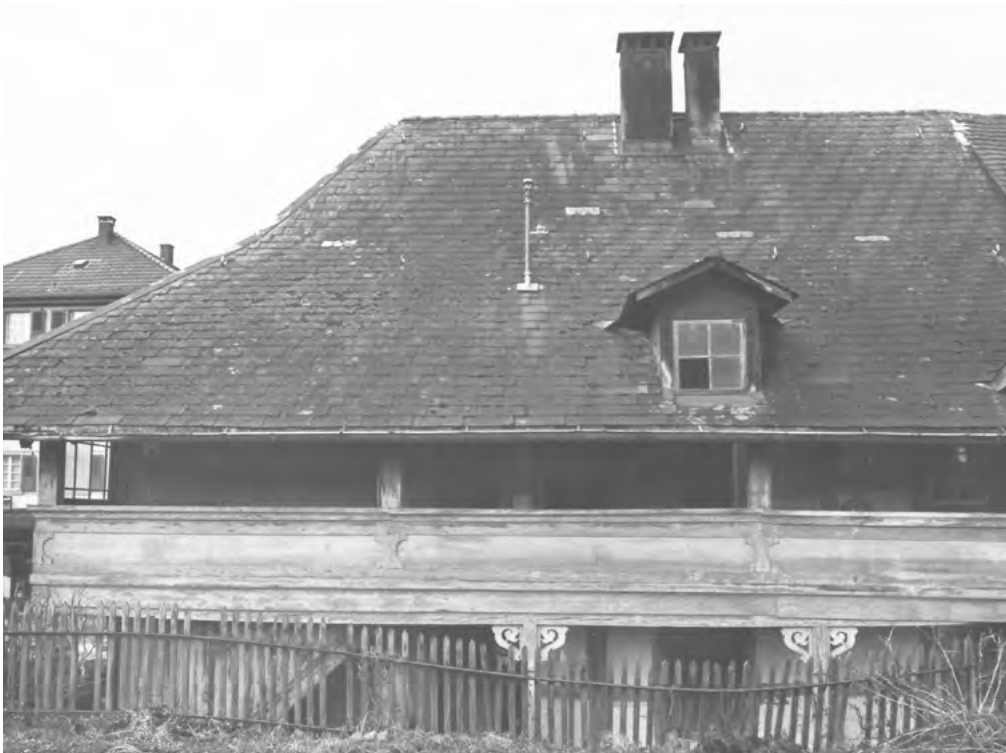
15 Herzogenbuchsee, ehemalige Zürichstrasse 36: Ober- und Dachgeschoss waren über den rückseitig im Osten angelegten Laubenaufgang zu erreichen. Blick nach Westen. Aufnahme vor 1984.
