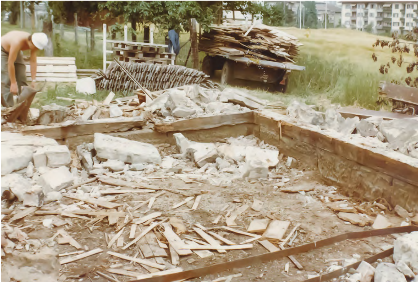
16 Köniz-Wabern, Stöckli Unteres Morillongut: Das Stöckli ist bereits bis zum Schwellenkranz hin vollständig abgebaut. Dazwischen liegen Reste der ehemaligen Ausfachung mit stehenden Sandsteinblöcken und Backsteinen. Ein Grossteil davon wurde für den Wiederaufbau geborgen. Aufnahme 1984.
