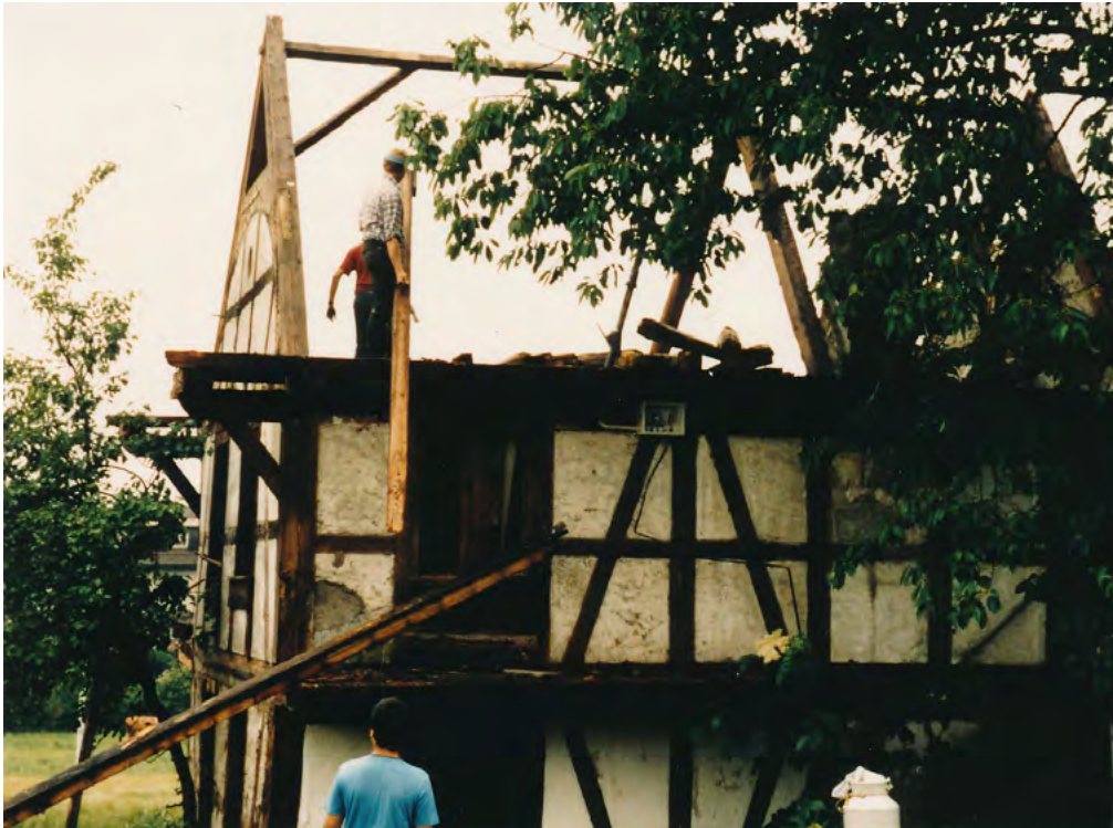
22 Köniz-Wabern, Stöckli Unteres Morillongut: Abbau des Stöckli vor Ort. Gerade wird das Dachwerk demontiert und danach wurden die darunterliegenden Fachwerkwände abgebaut. Bevor man die Bauteile abtrug, hatte man sie ordentlich beschriftet, um sie später beim Wiederaufbau korrekt einbauen zu können. Aufnahme 1984.
