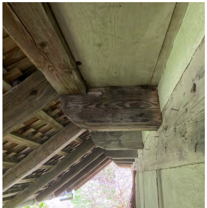
19 Freilichtmuseum der Schweiz, Stöckli Unterer Morillongut: Blick unter die Traufseite des Dachvorstands auf der heutigen Westseite des Stöckli. Der Dachvorsprung mit den Aufschieblingen wird von einer Flugfette getragen, die auf den Vorsprüngen der Ankerbalken liegt. Die Köpfe der Balken sind in zeittypisch schlichter Manier verziert. Aufnahme 2022.
