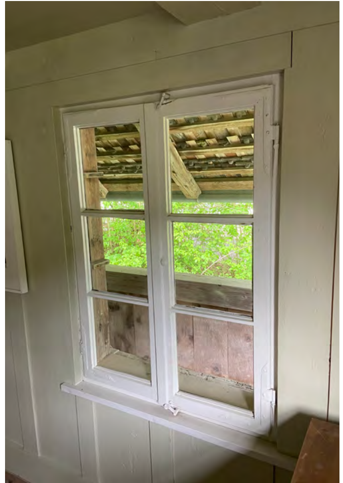
21 Freilichtmuseum der Schweiz, Stöckli Unteres Morillongut: Im Obergeschoss des Stöckli wurde die ursprüngliche Wandausstattung mit hellgrau gefasstem Täfer und den zweiflügeligen Fenstern des letzten Ausbauszustands wiederhergestellt. Aufnahme 2022.
