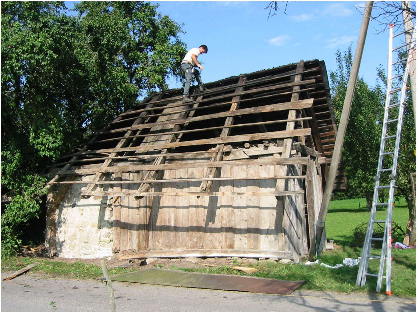
13 Breitenried, Ofenhaus: Beim Abbau wurde zunächst die Dachhaut entfernt, danach das Holzgerüst und letztlich die gemauerten Bestandteile. Blick nach Nordwesten. Aufnahme 2006.
