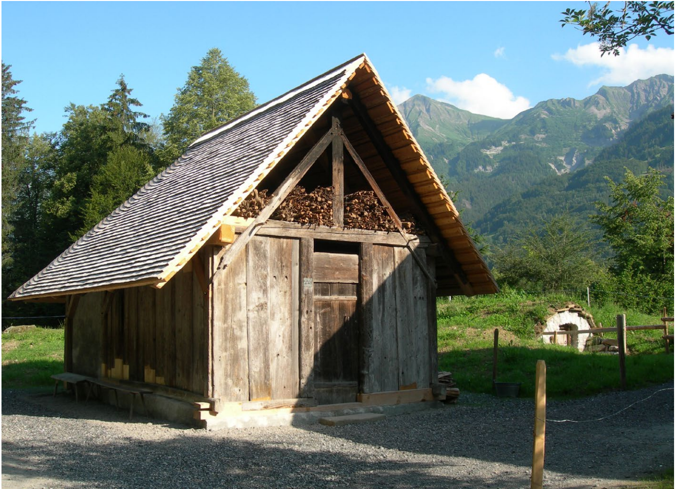
15 Freilichtmuseum der Schweiz, Ofenhaus aus Breitenried: Die wenigen ausgetauschten Holzelemente sind hier gut zu erkennen. Sie sind noch deutlich heller, als die teilweise russgeschwärzten Bestandbauteile. Blick nach Nordwesten. Aufnahme 2009.
