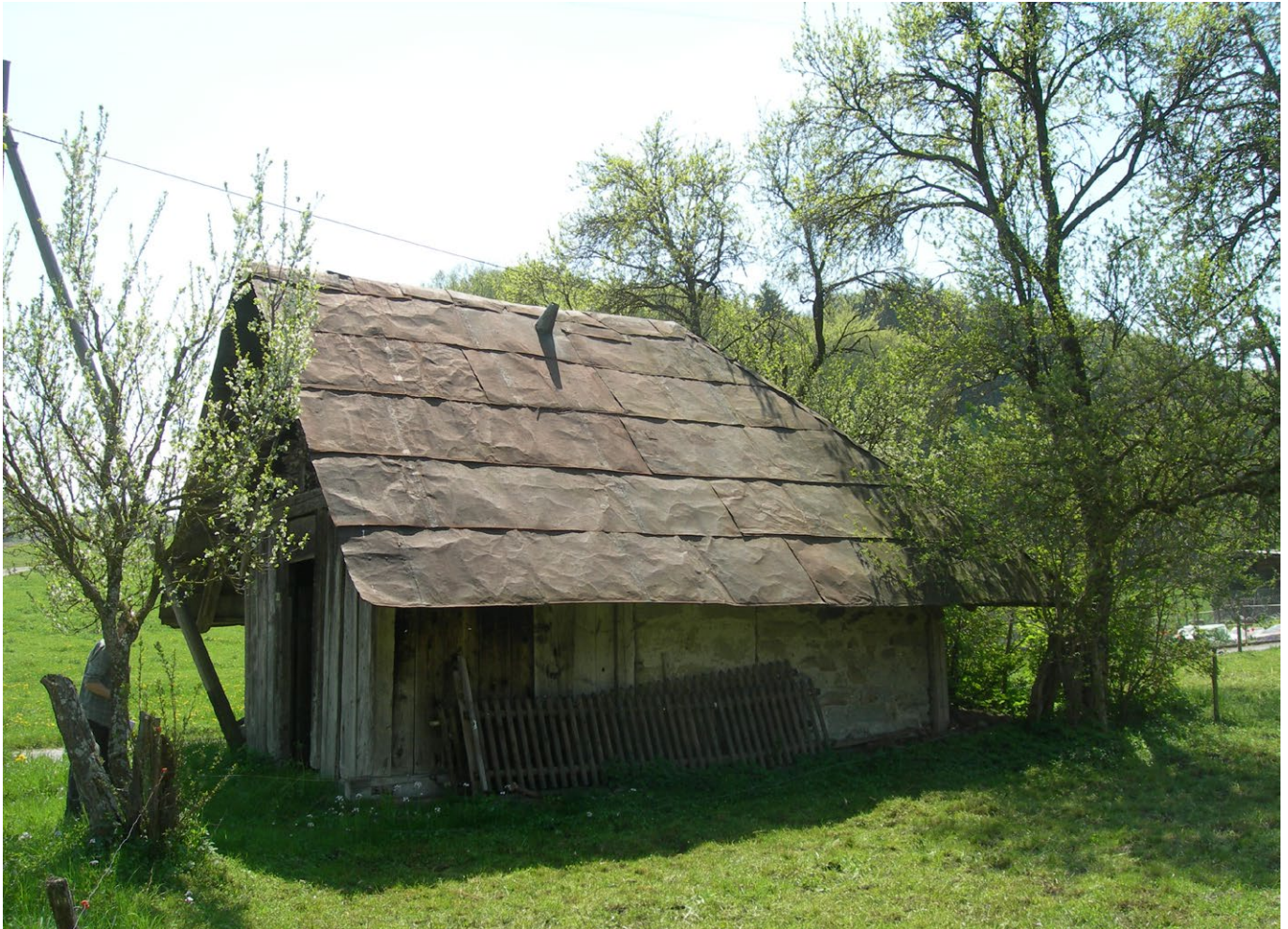
11 Breitenried, Ofenhaus: Zu einem unbekanntem Zeitpunkt wurde die einstige Schindeldeckung durch Blechbahnen ausgetauscht, beziehungsweise überdeckt. Blick nach Süden. Aufnahme 2006.
