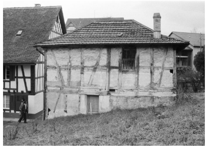
8 Rüslikon, ehemals Dorfstrasse 38: Die Nordfassade des Ökonomegebäudes. Das Gebäude wurde scheinbar zuletzt nicht mehr unterhalten, was sich an diversen Putzschäden bemerkbar machte. Blick nach Süden. Aufnahme ca. 1979.
