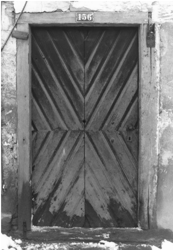
9 Rüschnikon, ehemals Dorfstrasse 38: Das aufwendig hergestellte Türblatt stellte mit seinem gespiegelten Fischgrätmuster den einzigen Bauschmuck am sonst schlicht gestalteten Ökonomiegebäude dar. Blick nach Norden. Aufnahme ca. 1979.
