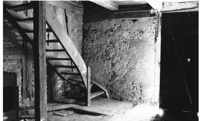
12 Rüschlikon, ehemals Dorfstrasse 38: Aus dem Vorraum im Erdgeschoss führte eine Treppe in das Obergeschoss. Blick nach Süden. Aufnahme ca. 1979.
