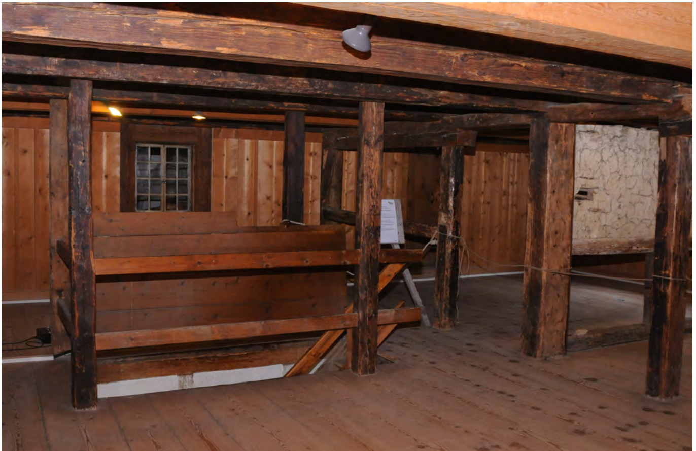
17 Freilichtmuseum der Schweiz, Bauernhaus aus Uesslingen: Obergeschoss nach dem Wiederaufbau. Blick auf das in der ehemaligen östlichen Aussenwand des Wohnteils erhaltene Fenster. Blick nach Osten. Aufnahme 2017.
