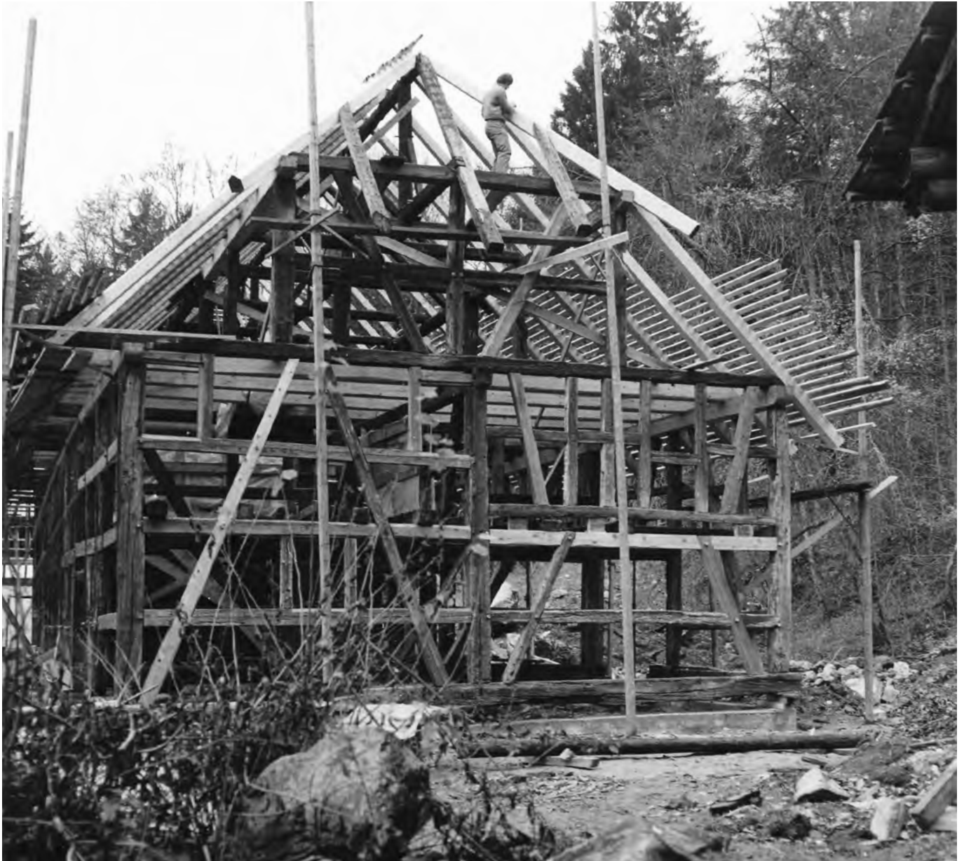
27 Freilichtmuseum der Schweiz, Bauernhaus aus Uesslingen: Wiederaufbau des Ständerbaus im Freilichtmuseum, Erstellen des Dachwerks mit dem Krüppelwalm auf der Ostseite. Blick nach Westen. Aufnahme 1976.
