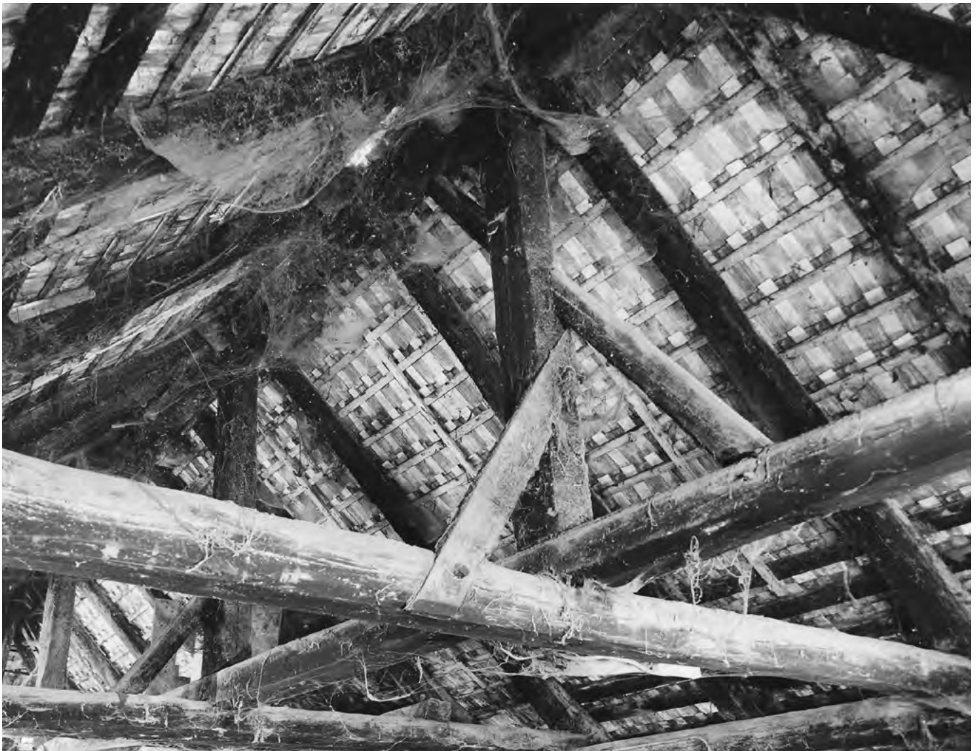
19 Uesslingen, Hugen-Haus: Blick in den Dachraum des westlichen Hausteils mit dem verblatteten Dachwerk, bestehend aus First und Unterfirst, Kehlbalkenlage, abgefangenen Firstständern sowie kurzen Fussbändern und langen Bändern als Längsausteiung zwischen First und Unterfirst. Blick nach Westen. Aufnahme 1976.
