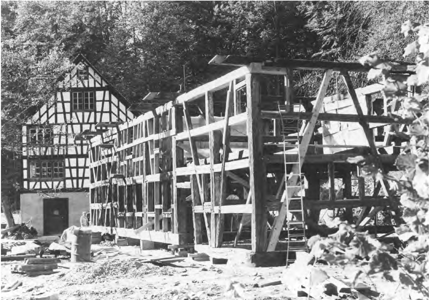
26 Freilichtmuseum der Schweiz, Bauernhaus aus Uesslingen: Wiederaufbau des Ständerbaus im Freilichtmuseum. Im Hintergrund steht bereits das Haus aus Richterswil. Blick nach Westen. Aufnahme 1976.
