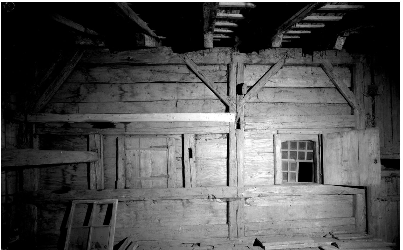
26 Wila, Huswies: Dokumentation des überkommenen Bauzustands. Blick auf die Ostfassade im ersten Obergeschoss vom Schopf. Blick nach Westen. Aufnahme 1979.
