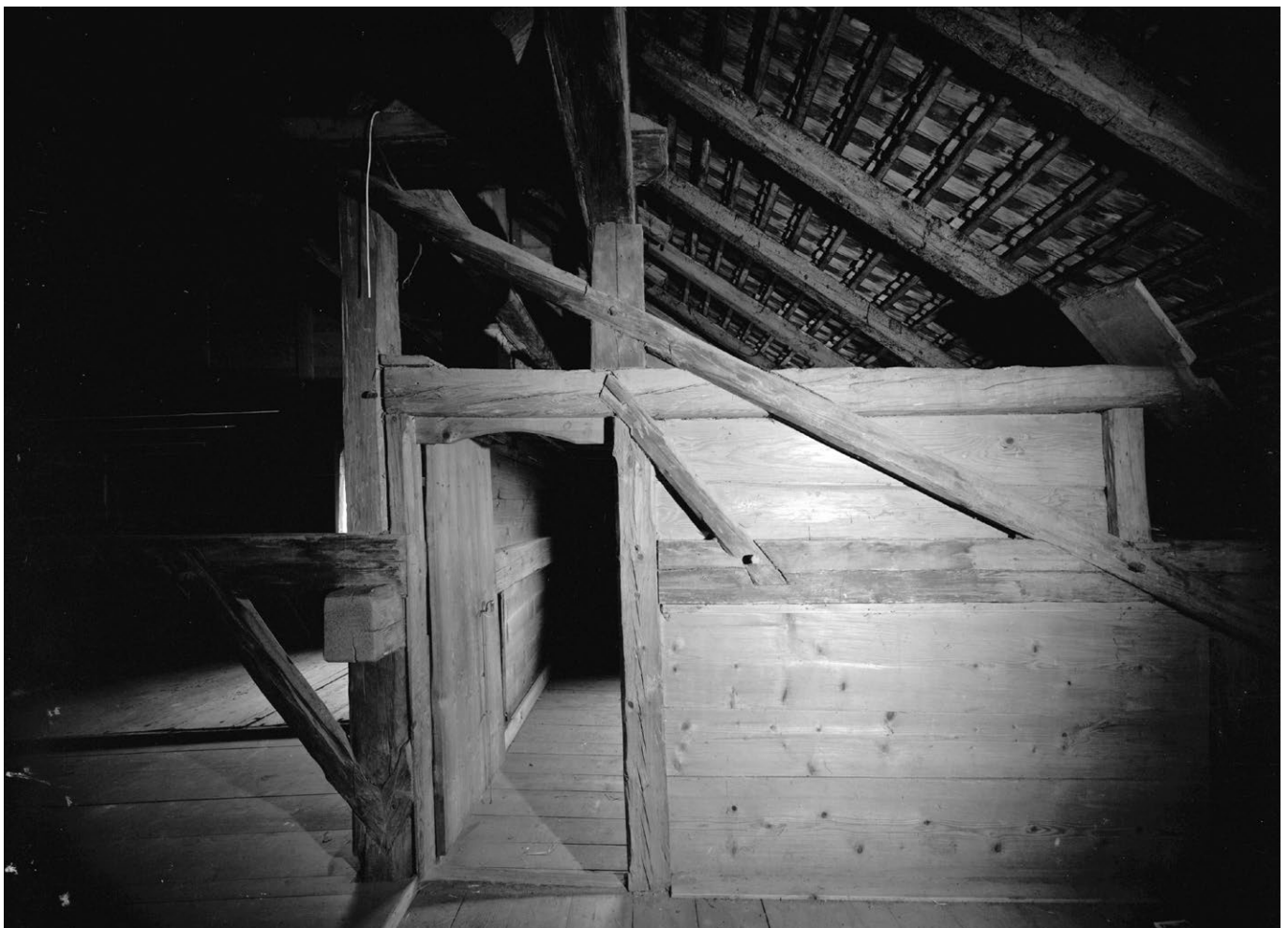
17 Wila, Huswies: Dachkammer im Estrich des Hauses, vor dem Rückbau. Blick nach Süden. Aufnahme 1979.
