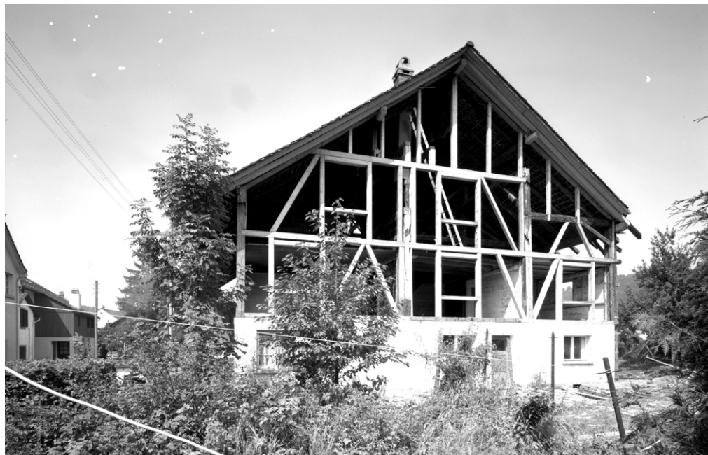
14 Wila, Huswies: Südfassade des Hauses Rüegg nach Rückbau der Fassadenverkleidung. Blick nach Norden. Aufnahme 1979.
