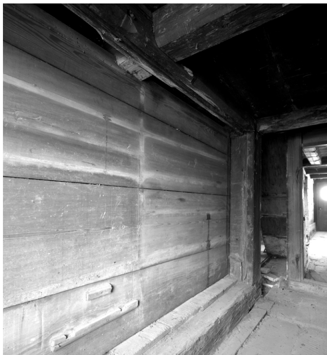
21 Wila, Huswies: Verbreiterter Quergang, das sogenannte Ern, beziehungsweise die sogenannte Salzkammer zum Zeitpunkt des Rückbaus. Blick nach Westen. Aufnahme 1979.
