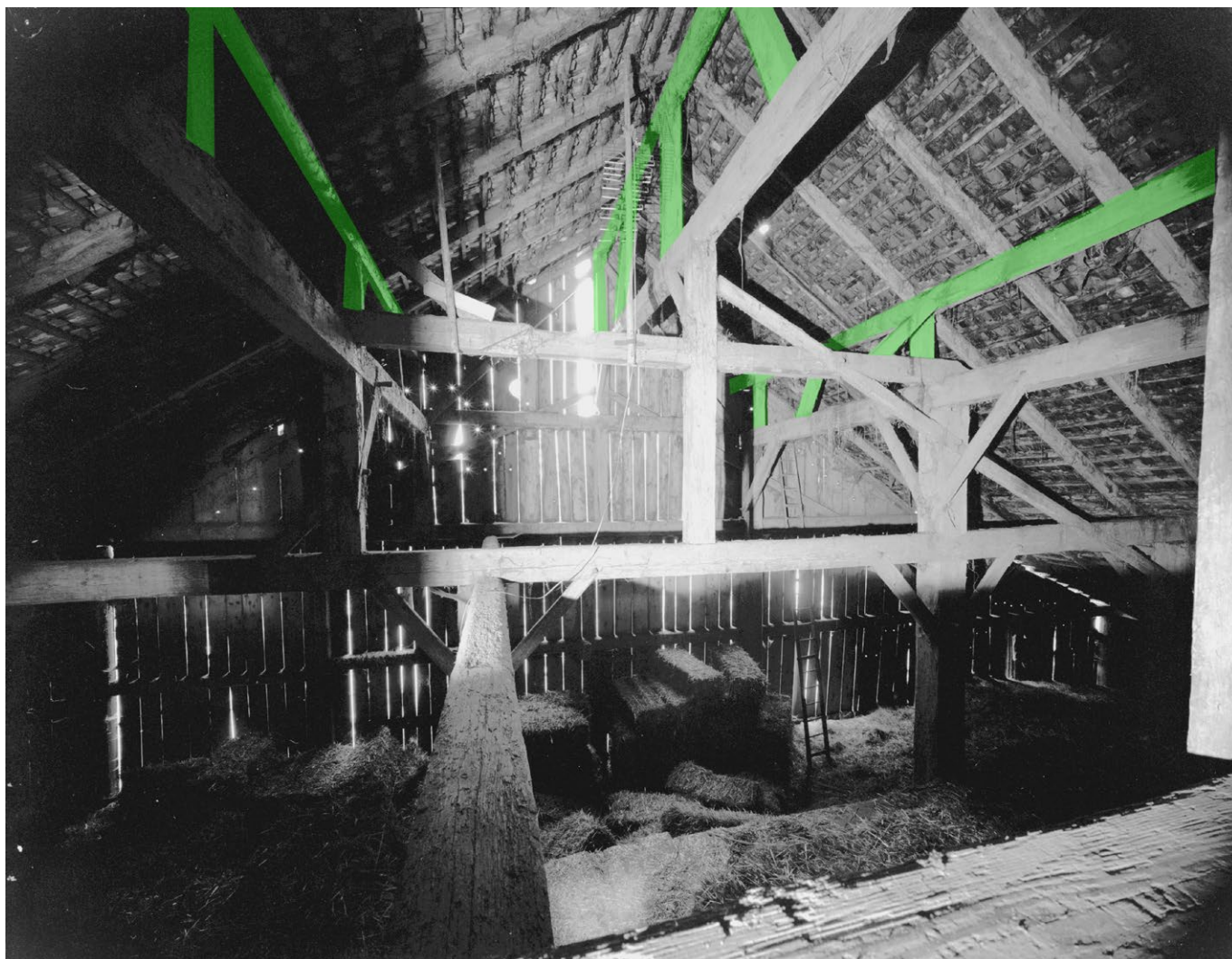
15 Wila, Huswies: Innenaufnahme des Dachstuhls im Bereich des Ökonomieteils mit späteren Aufbauten, auf der Abbildung grün markiert. Blick nach Norden. Aufnahme 1979.
