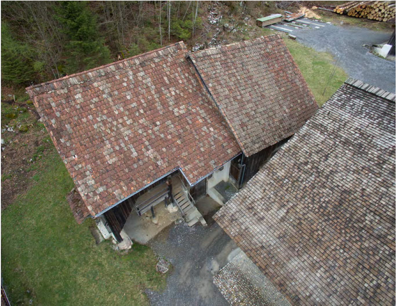
16 Freilichtmuseum der Schweiz, Speicherzeile aus Tagelswangen: Drohnenaufnahme der zweiteiligen Dachlandschaft des Speichergebäudes. Im Vordergrund ist das Dach des Bauernhauses aus Wila ZH angeschnitten. Blick nach Nordosten. Aufnahme 2016.
