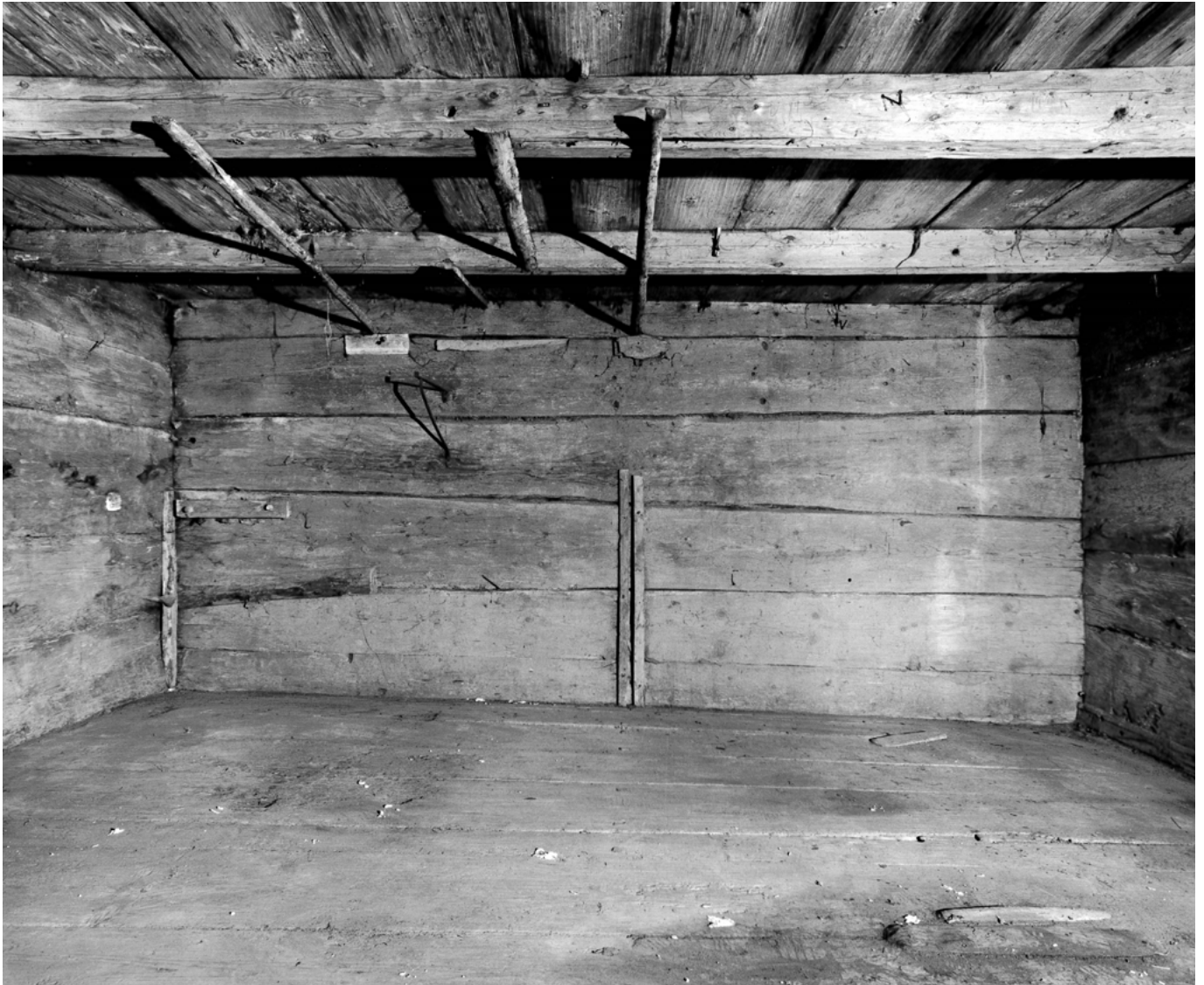
9 Tagelswangen, Huebstrasse: Blick in das hölzerne Speichergeschoss des ältesten Teils der Speicherzeile der Zeit um 1534. Blick nach Nordosten. Aufnahme 1985/86.
