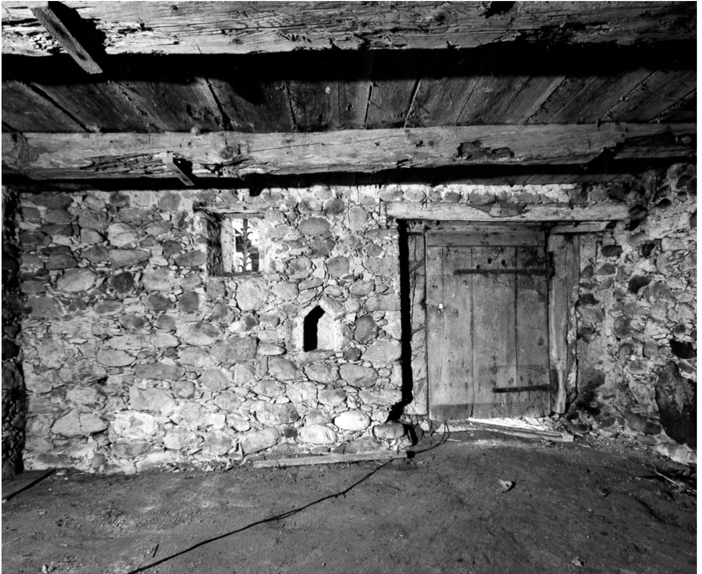
10 Tagelswangen, Huebstrasse: Blick in das aus grossen Bollensteinen gefügte Kellergeschoss des ältesten Teils der Speicherzeile aus der Zeit um 1534. Charakteristisch ist die giebelförmige Lichtnische neben der Zugangstür. Blick nach Nordwesten. Aufnahme 1985/86.
