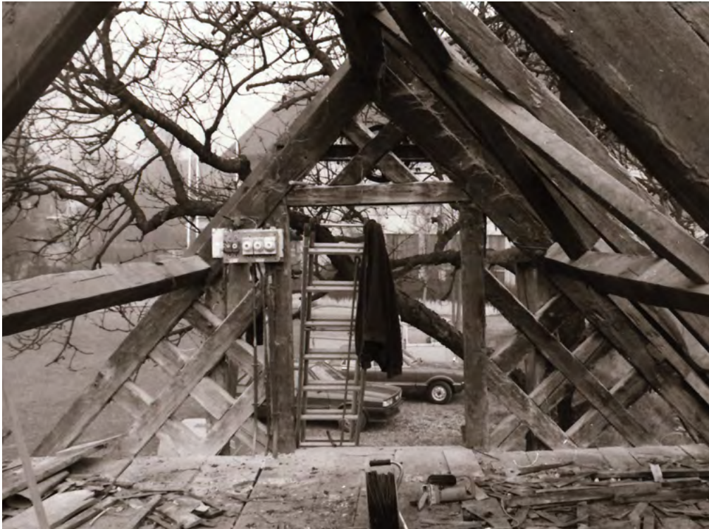
11 Knonau, Stampfstrasse: Foto vom Abbau der Knochenstampfe. Das nordöstliche Giebfeld wurde durch überblattete Streben gestalterisch hervorgehoben. Die Streben waren in die Stuhlsäulen eingezapft. Blick nach Nordosten. Aufnahme 1984.
