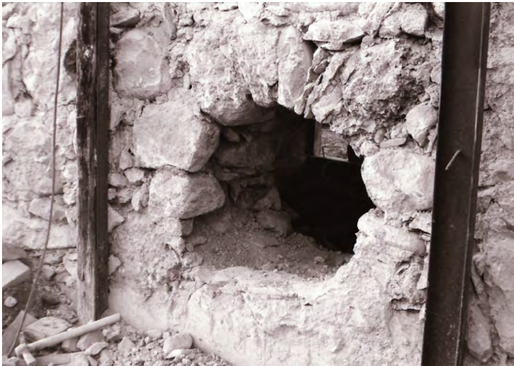
9 Knonau, Stampfistrasse: Das Loch in der Südostwand, über welches das aussenliegende Wasserrad mit der innenliegenden Nockenwelle verbunden war, kam erst bei den Abbauarbeiten 1984 wieder zum Vorschein. Es wurde zugemauert, nachdem das Wasserrad entfernt worden war. Blick nach Nordwesten. Aufnahme 1984.
