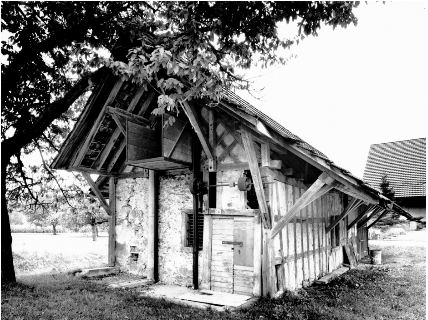
12 Knonau, Stampfstrasse: Um den Lastenaufzug an der Nordostseite der Knochenstampfe und eine früher an der Nordwestseite installierte Langholzfräse zu schützen, wurde der Dachüberstand auf beiden Seiten verlängert und mit Bügen am Gebäude abgestützt. Blick nach Norden. Aufnahme undatiert.
