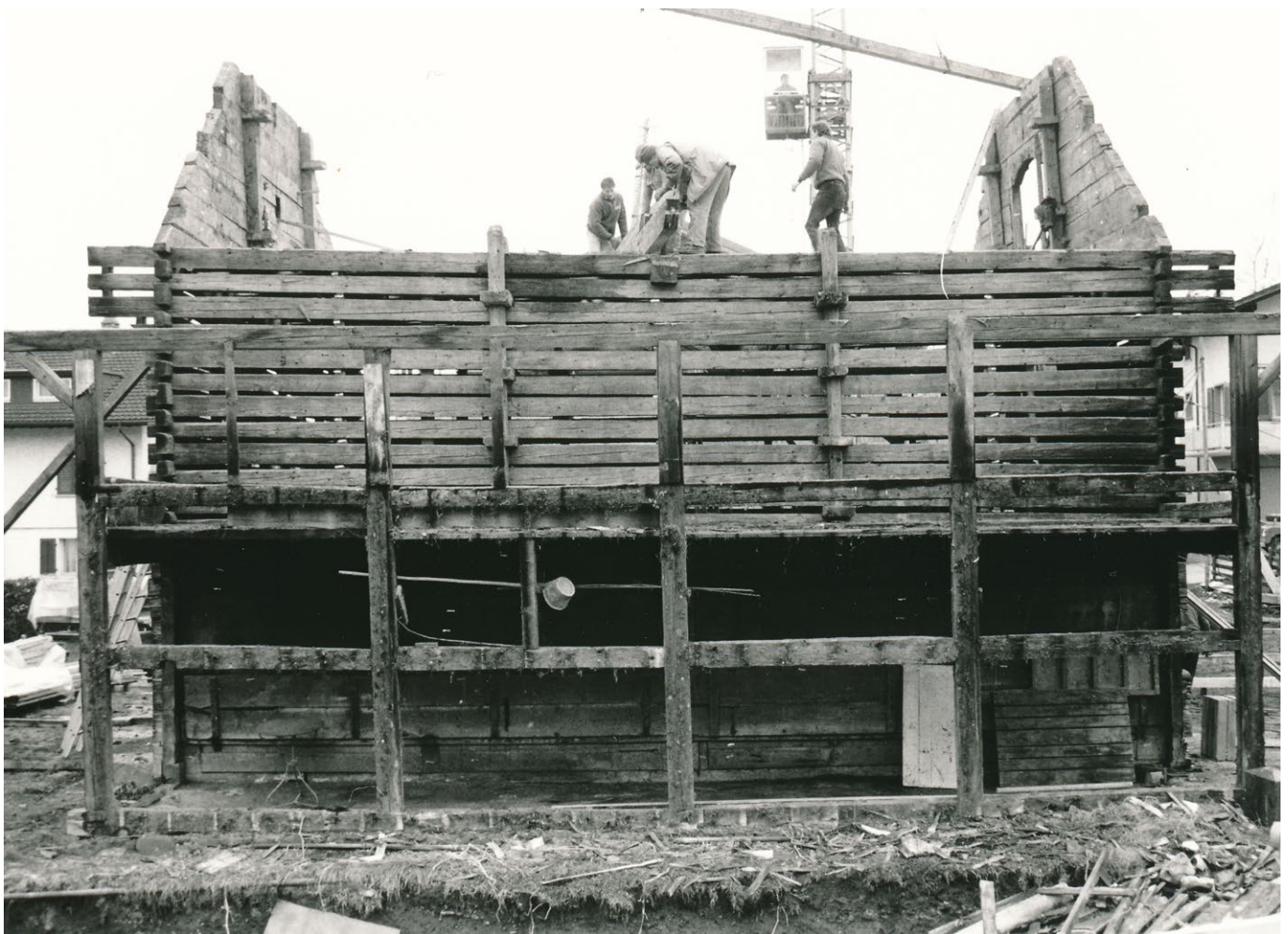
13 Sachseln, Stallscheune Haltenmatte: Der auf der Ebene des Heubodens locker gefügte Blockbau wurde an allen Gebäudeseiten mittels Blockzangen stabilisiert. Das Ständerwerk des Futtertrens und der darüberliegenden Laube wurden zu einem unbekanntem Zeitpunkt erneuert. Blick nach Südwesten. Aufnahme 1991.
