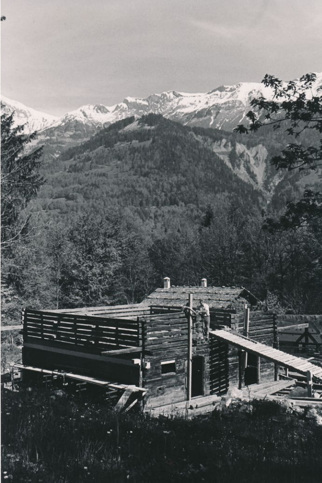
18 Freilichtmuseum der Schweiz, Stallscheune aus Sachseln: Die Stallscheune Haltenmatte im Wiederaufbau. Der Zustand der Holzbauteile war so gut, dass sie beinahe sämtlich übernommen werden konnten. Blick nach Norden. Aufnahme 1991.
