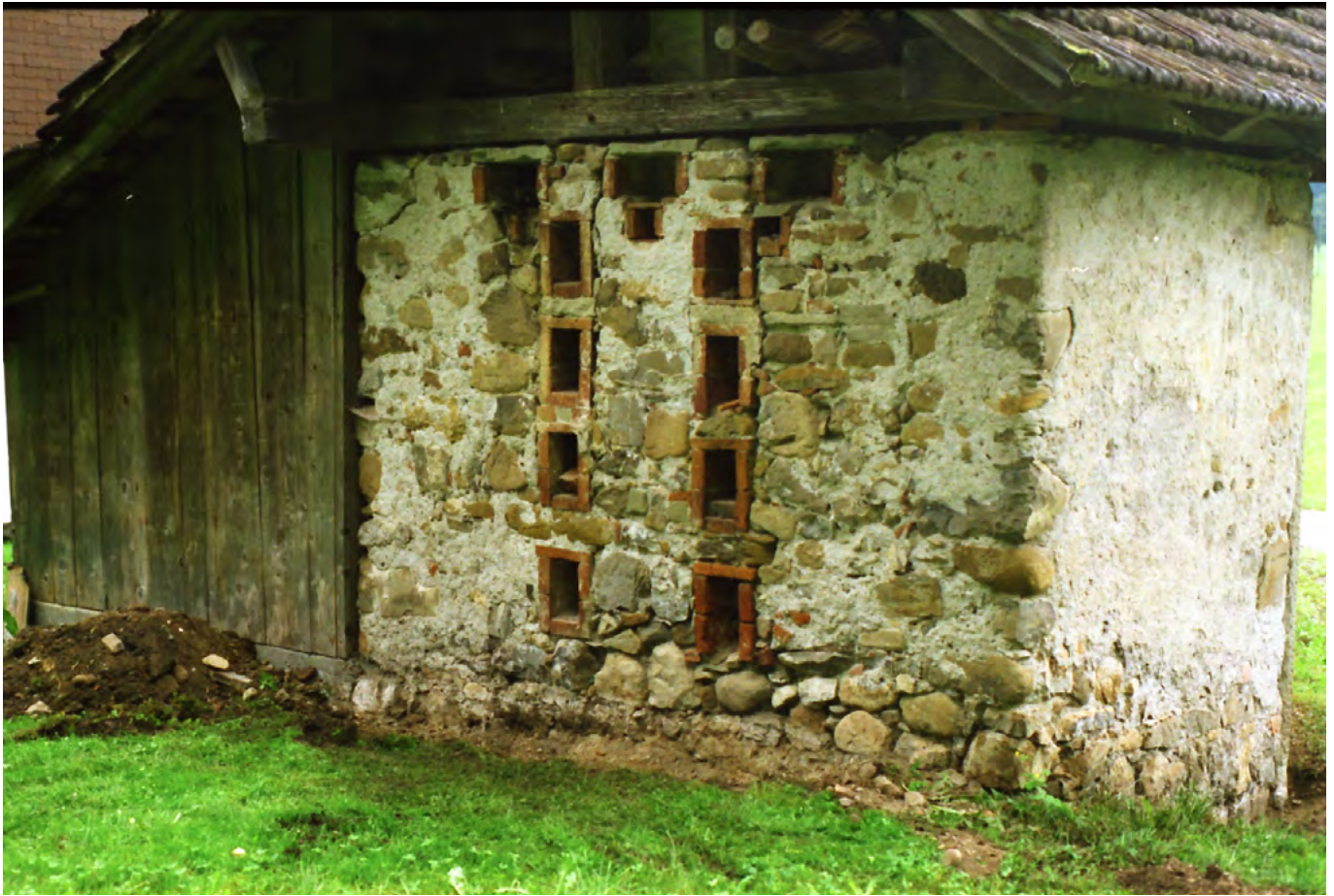
13 Alpnachstad, Hof Rothenbächli: Die Rückseite des Dörrofens. Die vertikalen Öffnungen dienten der Wartung der Rauchkanäle. Über die horizontalen Öffnungen konnte der beim Dörren entstehende Wasserdampf aus den Kammern abgelassen werden. Blick nach Südosten. Aufnahme 2000.
