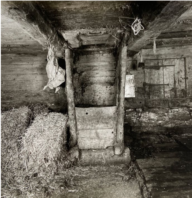
14 Spiringen, Heustall: Der mittige Heuabwurfschacht, die Ritschi, auf der nördlichen Bergseite des Stalls. Über die Öffnung wurde das Heu direkt vom oberen Heuraum in den Stall gebracht. Blick nach Norden. Aufnahme 1984.
