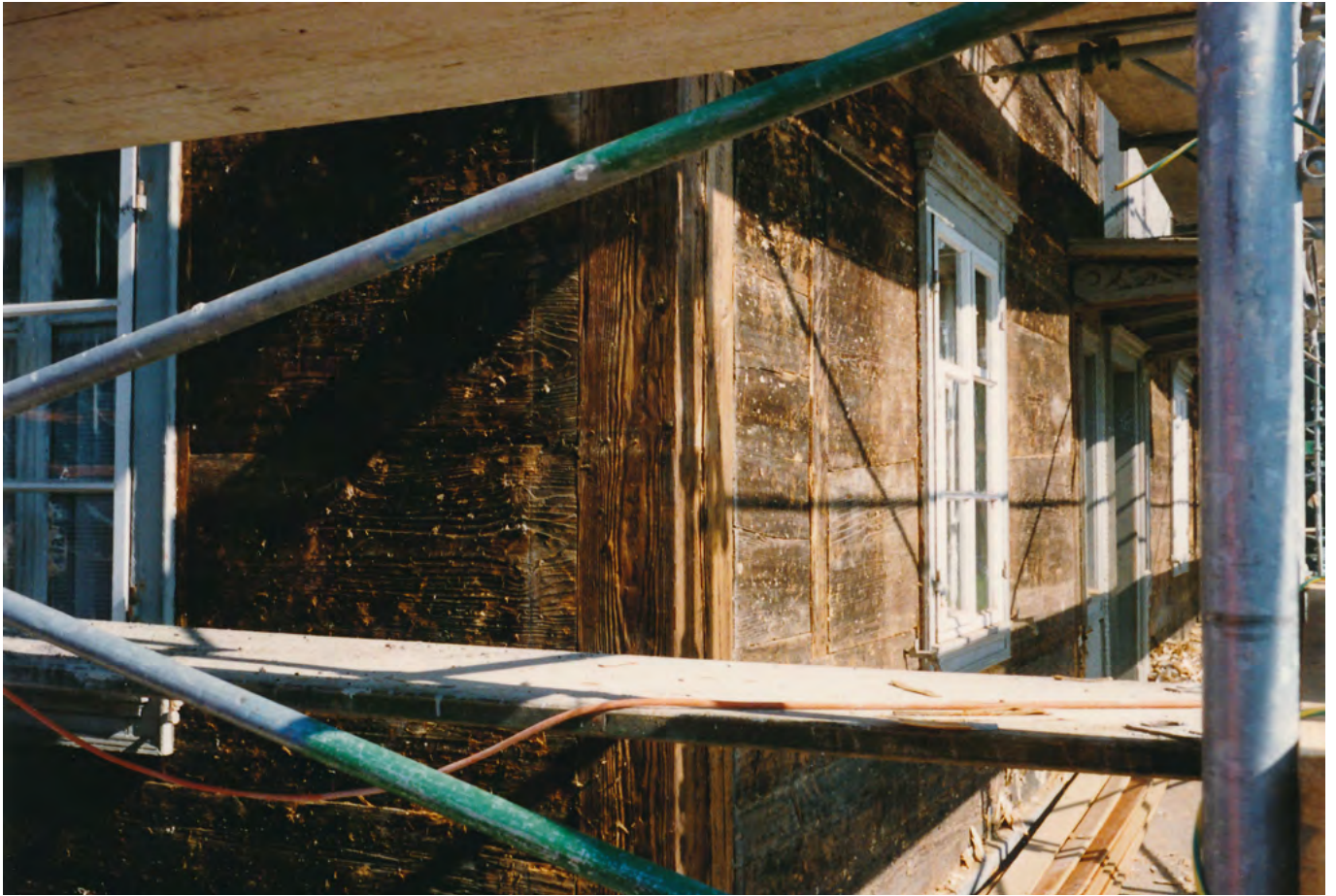
9 Hünenberg, Chamerstrasse 9: Nach teilweiser Entfernung des Schindelschirms zeigte sich die Grundkonstruktion des Baus. Blick nach Nordwesten. Aufnahme 1991.
