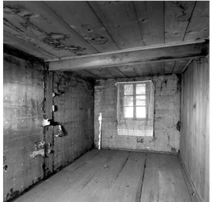
16 Escholzmatt-Wissemmen: Das Haus in ausgeräumtem Zustand kurz vor den Abbauarbeiten. Blick in die eine Kammer im Obergeschoss. Auch hier blieb die Raumausstattung sehr einfach. Im Laufe des 20. Jahrhunderts wurden Tapeten auf die Blockwände aufgebracht. Aufnahme 1997.
