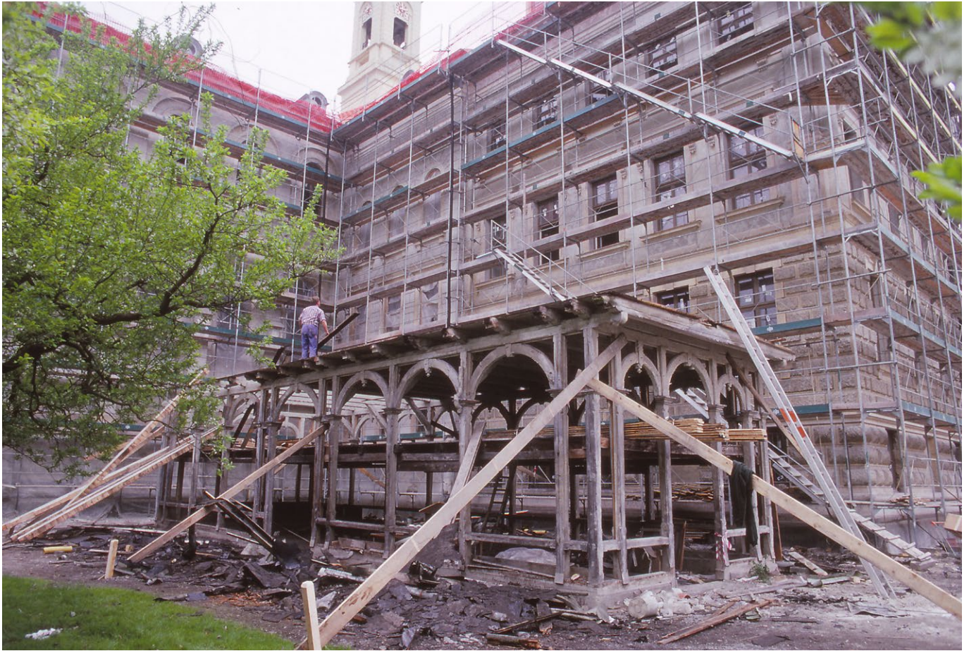
7 Sarnen, Brünigstrasse. Die Spielhalle während der Abbauarbeiten. Neben dem grossen Gymnasium wirkte der Bau klein, was prompt bei der Standortsuche im Freilichtmuseum zu Schwierigkeiten führte. Aufnahme 1997.
