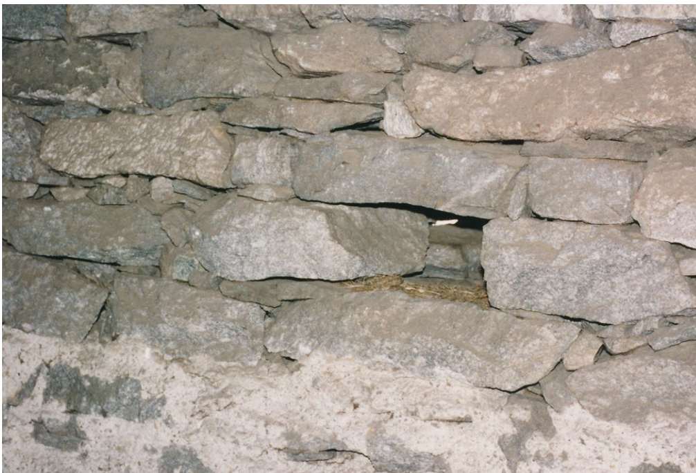
9 Pollegio, Heustall: Detailansicht des Übergangs von dem mit Kalkmörtel aufgeführten Mauerwerk zur Trockenbauweise. Aufnahme wohl 1999.
