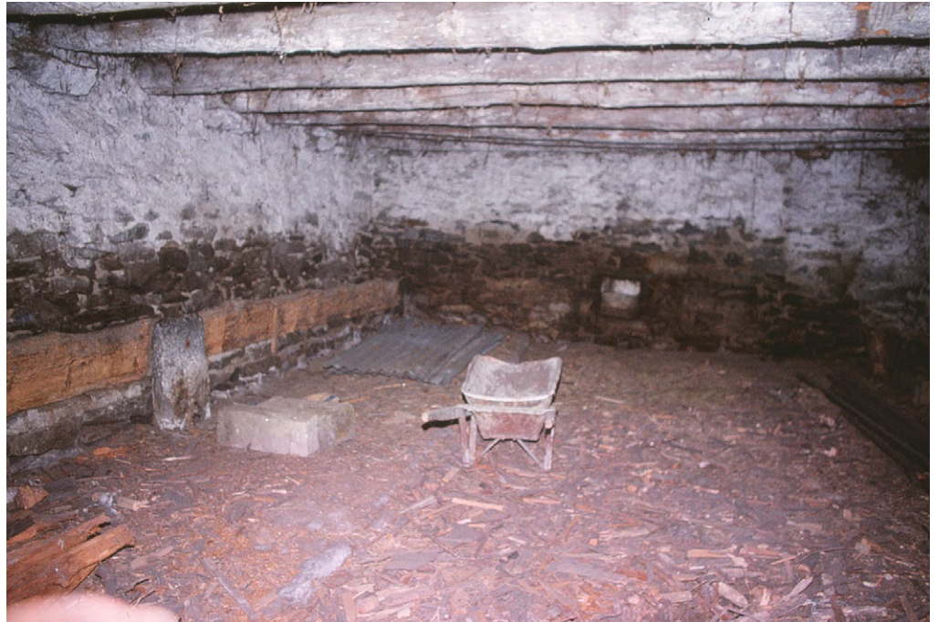
10 Pollegio, Heustall: Der Stallraum mit einer der längsseitig angeordneten Futterkrippen. Aufnahme wohl 1999.
