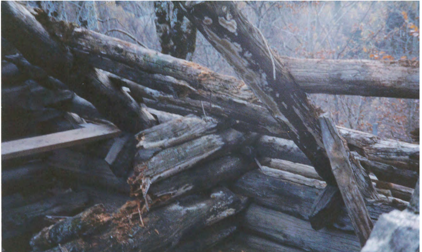
8 Campo (Vallemaggia), Piano di Campo: Speicher am alten Standort. Blick nach Nordwesten. Aufnahme 1999.
