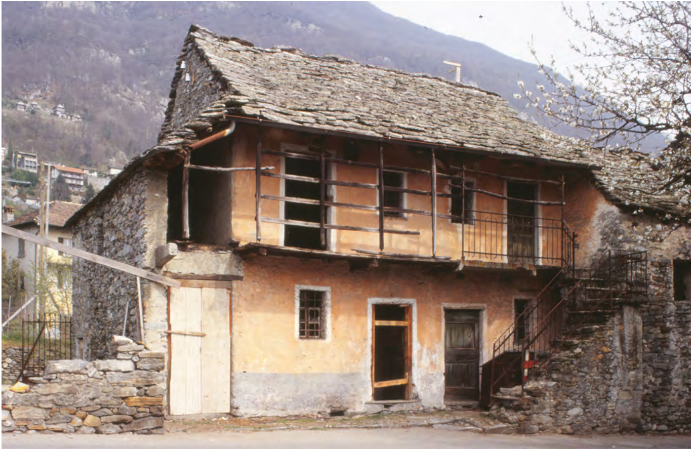
32 Cugnasco, Wohnhauskomplex: Doppelwohnhaus: Fotografie mit Blick auf die Südfassade während der Bauuntersuchung vor und während des Abbaus. Blick nach Norden. Aufnahme Mai 2000.
